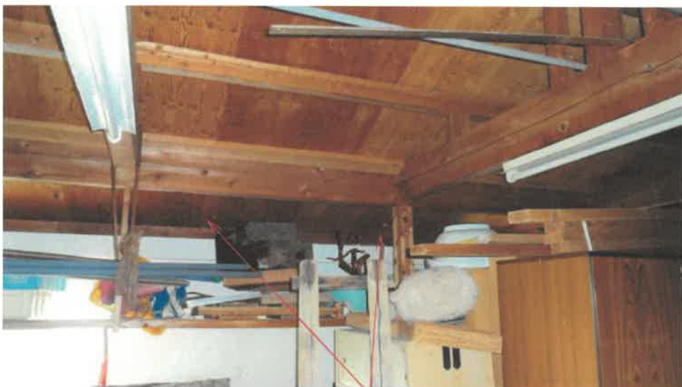
前同（雨漏り跡）
