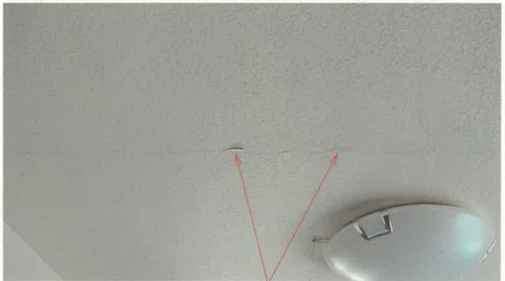
前同（天井クロス剥がれ）
