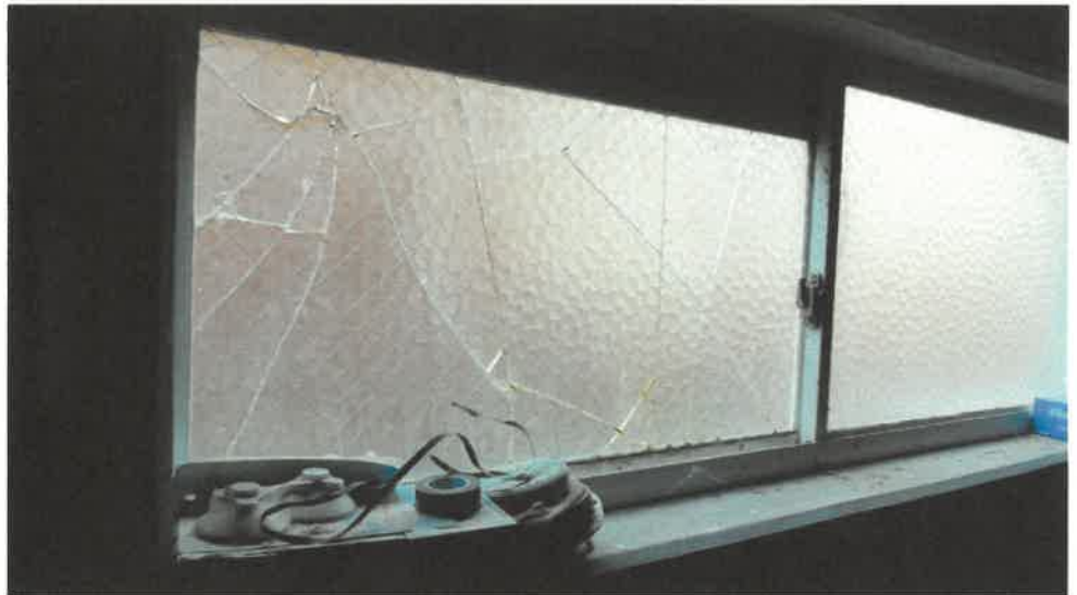
前同（窓ガラスが割れている）
