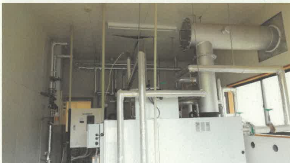
前同（天井板が一部破損）
