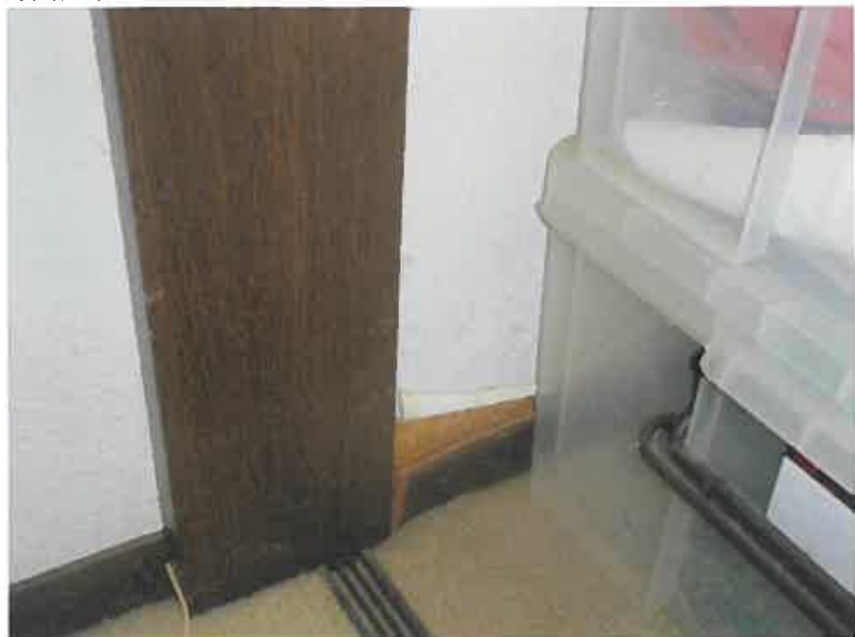
物件 2 2階洋室収納部のクロス剥がれ
