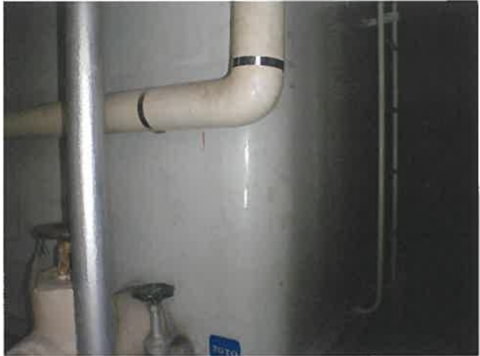
物件 2 5階水槽室
