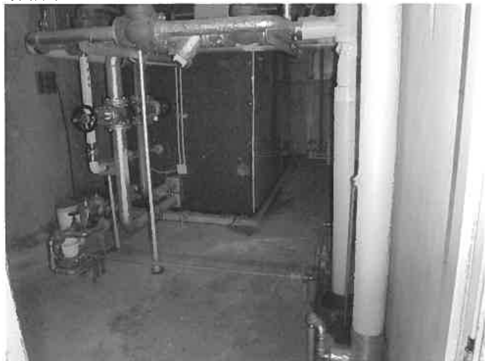
物件 2 3階機械室
