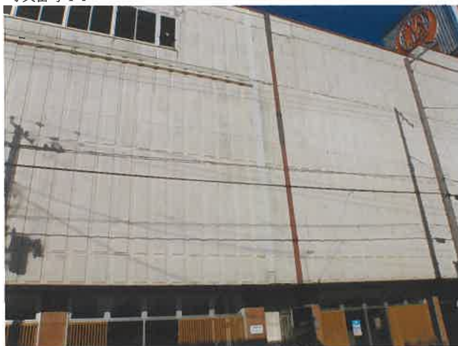
物件 2 南側外壁（補修されている模様）
