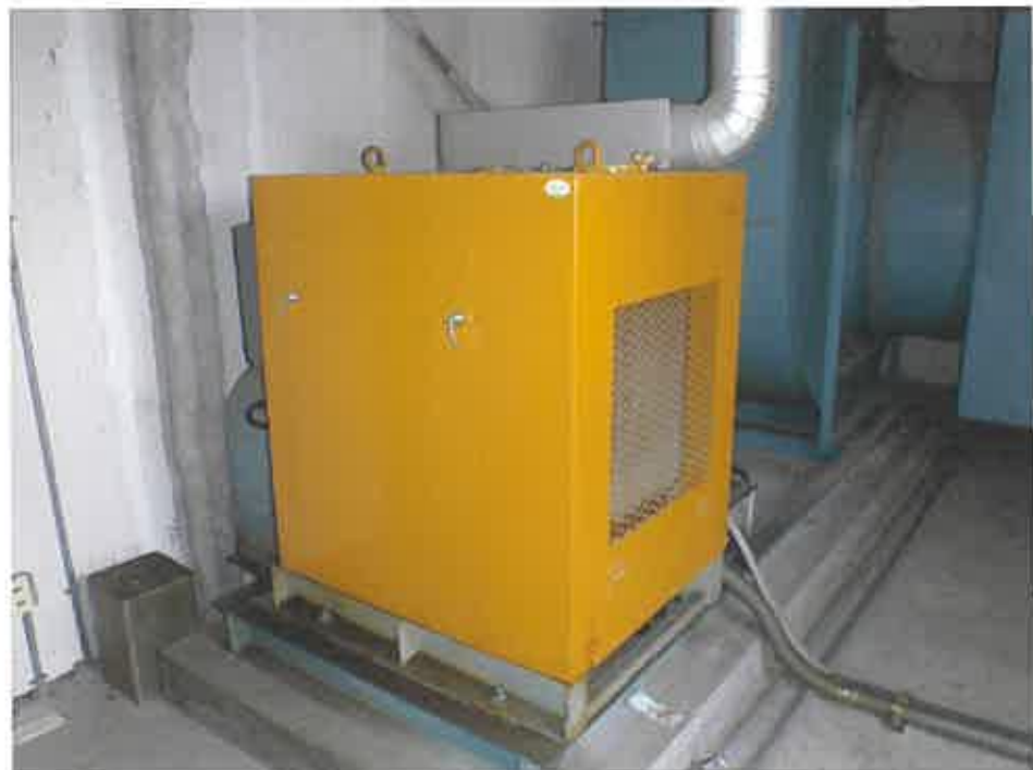
物件2 5階機械室
