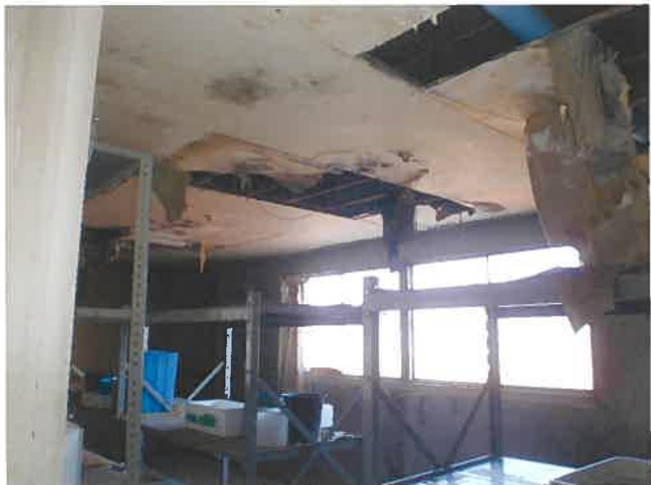
物件 2 4階倉庫（天井が破損している）
