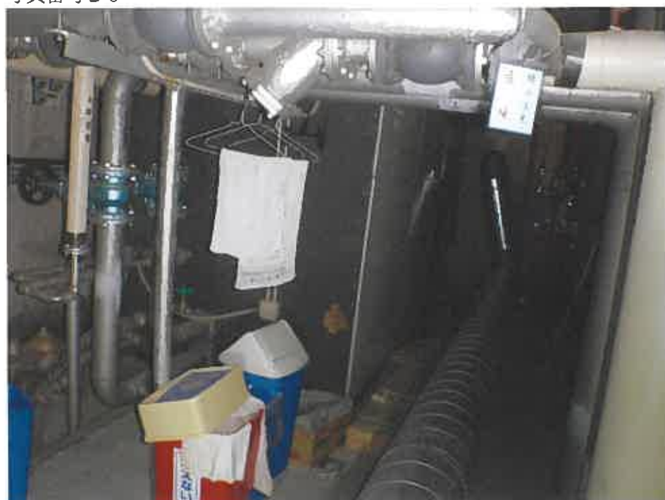
物件 2 2階機械室
