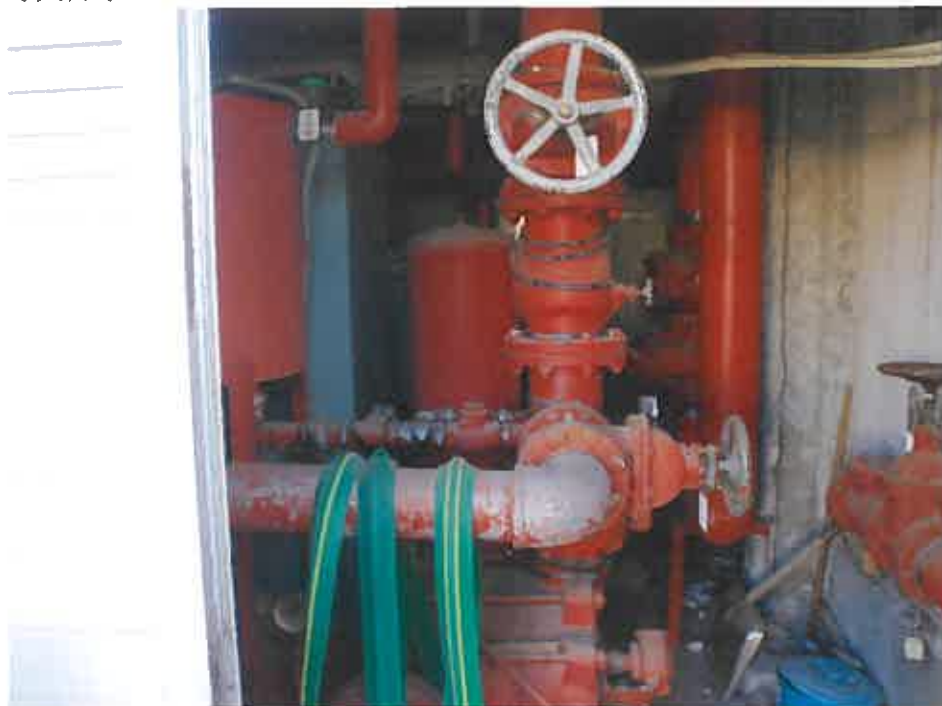
物件2 1階機械室
