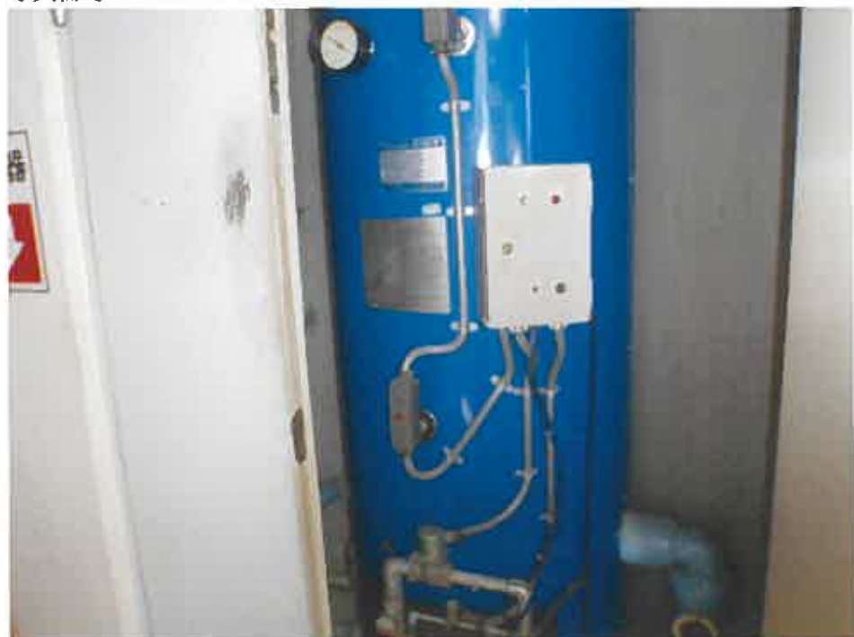
物件2 4階ボイラー
