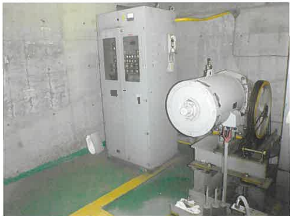
物件 2 5階エレベーター機械室
