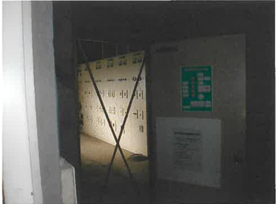
物件2 5階電気室
