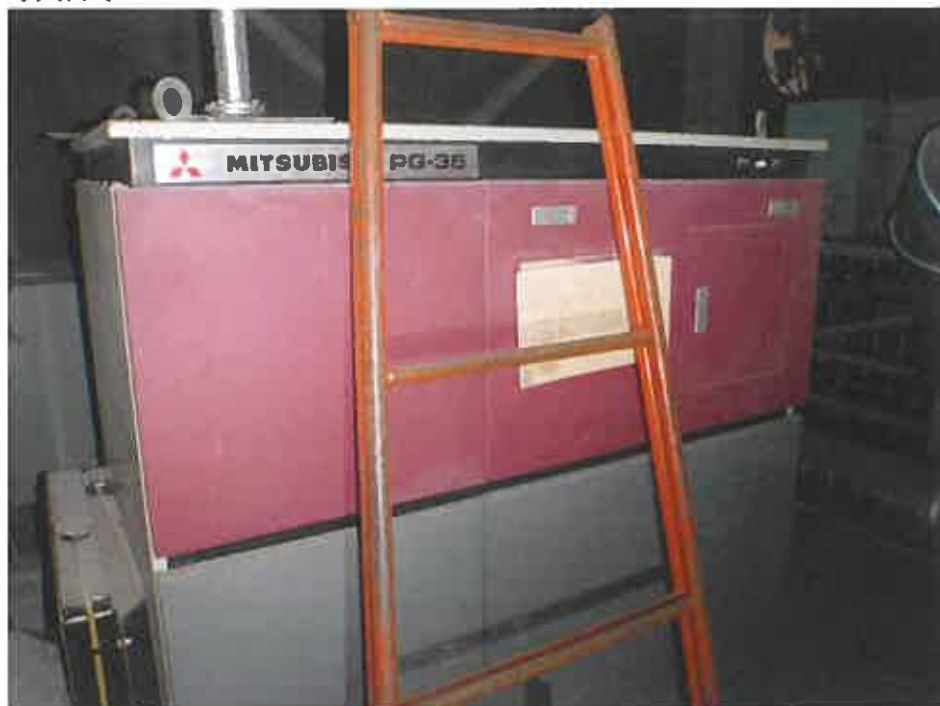
物件 2 2階発電室
