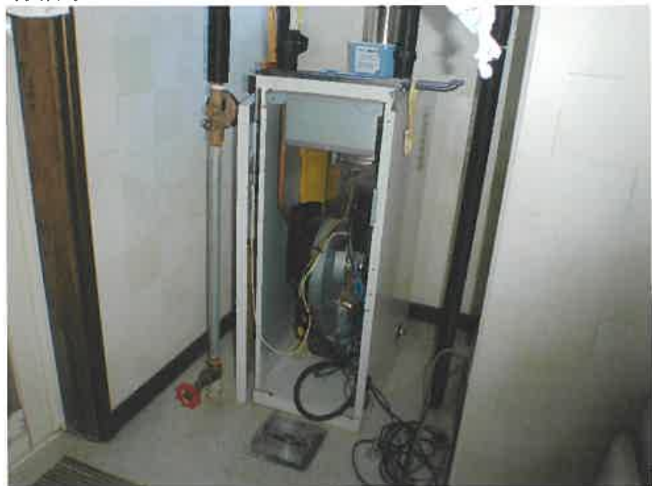
物件1 ボイラー
