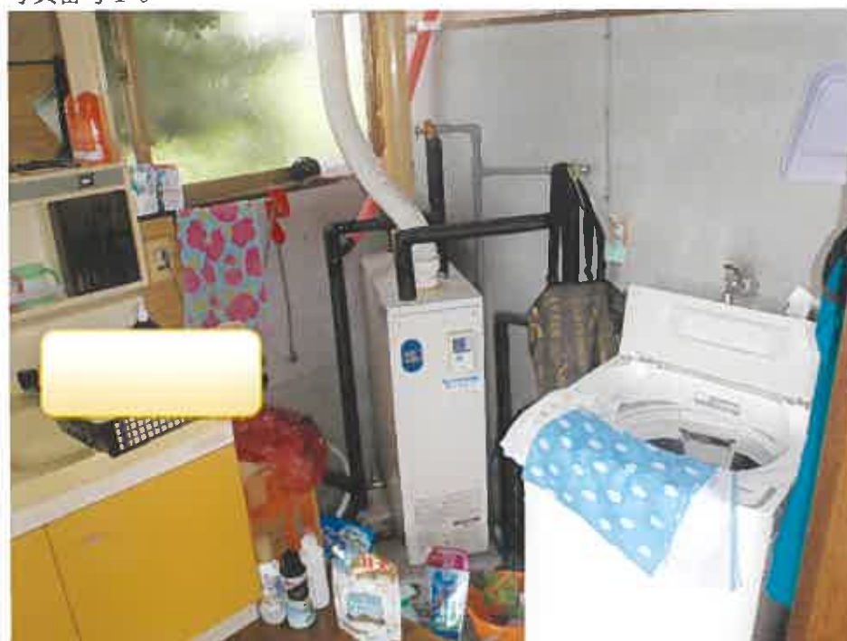
物件 6 ボイラー
