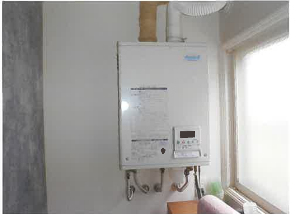
物件 2 ボイラー
