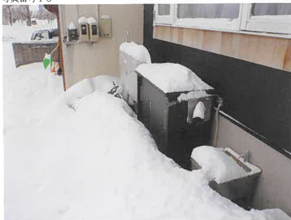
物件1 北側に設置されている融雪設備
