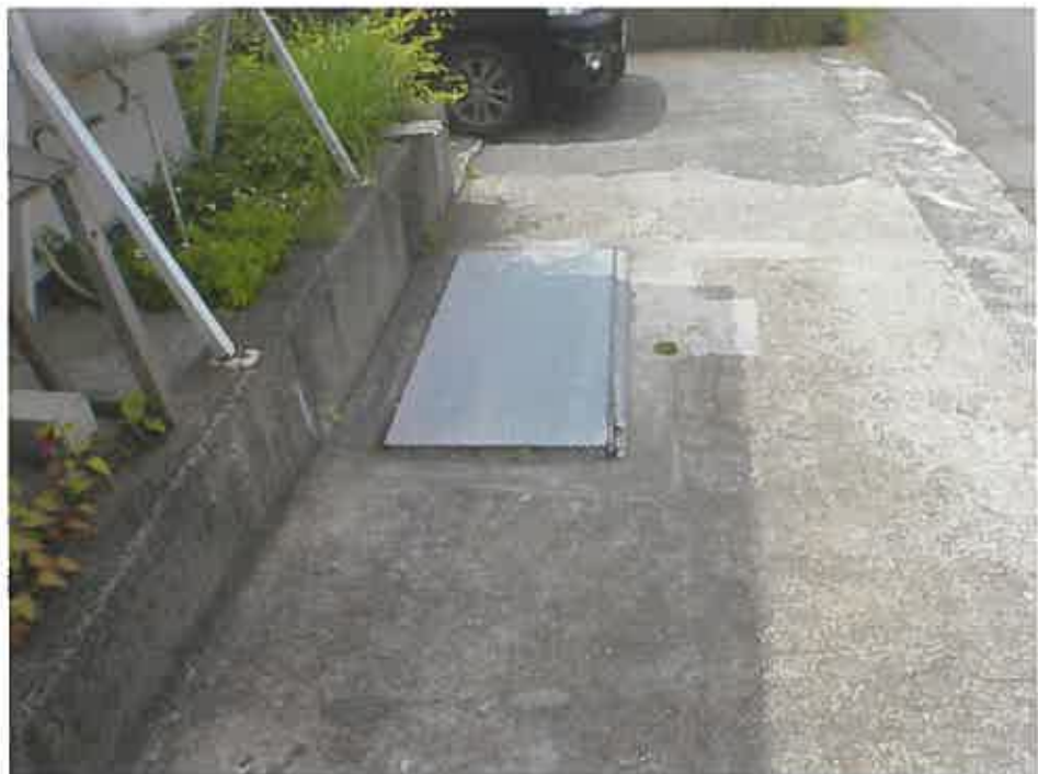
物件 1 にある融雪設備
