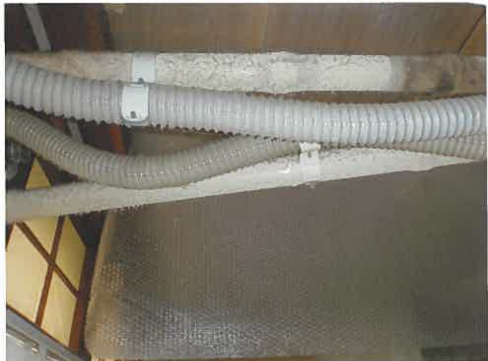
物件 3 水漏れしている模様の給排水管
