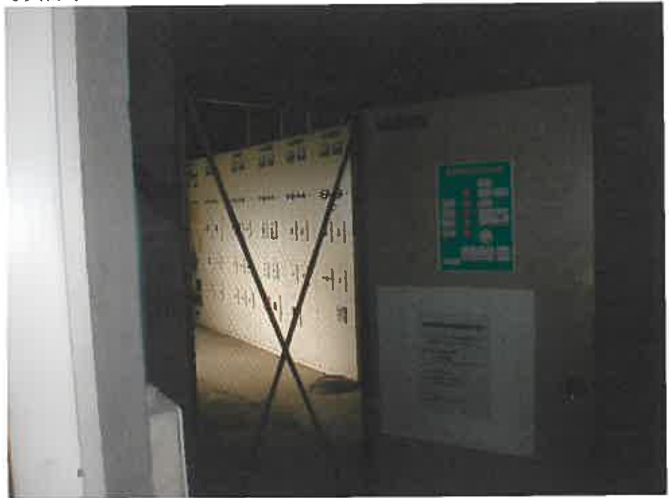
物件2 5階電気室
