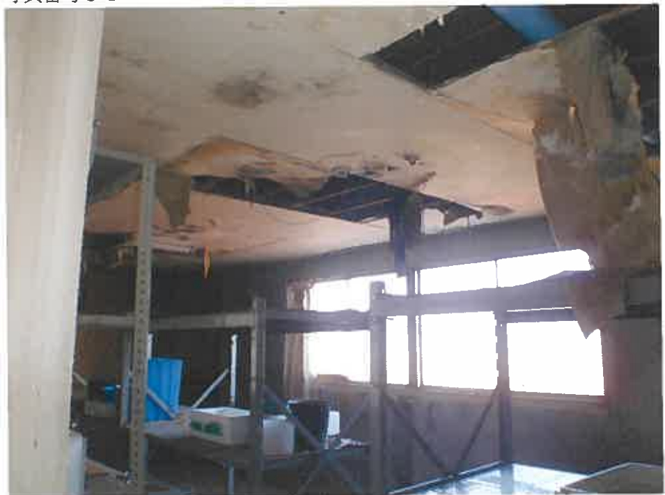
物件 2 4 階倉庫（天井が破損している）
