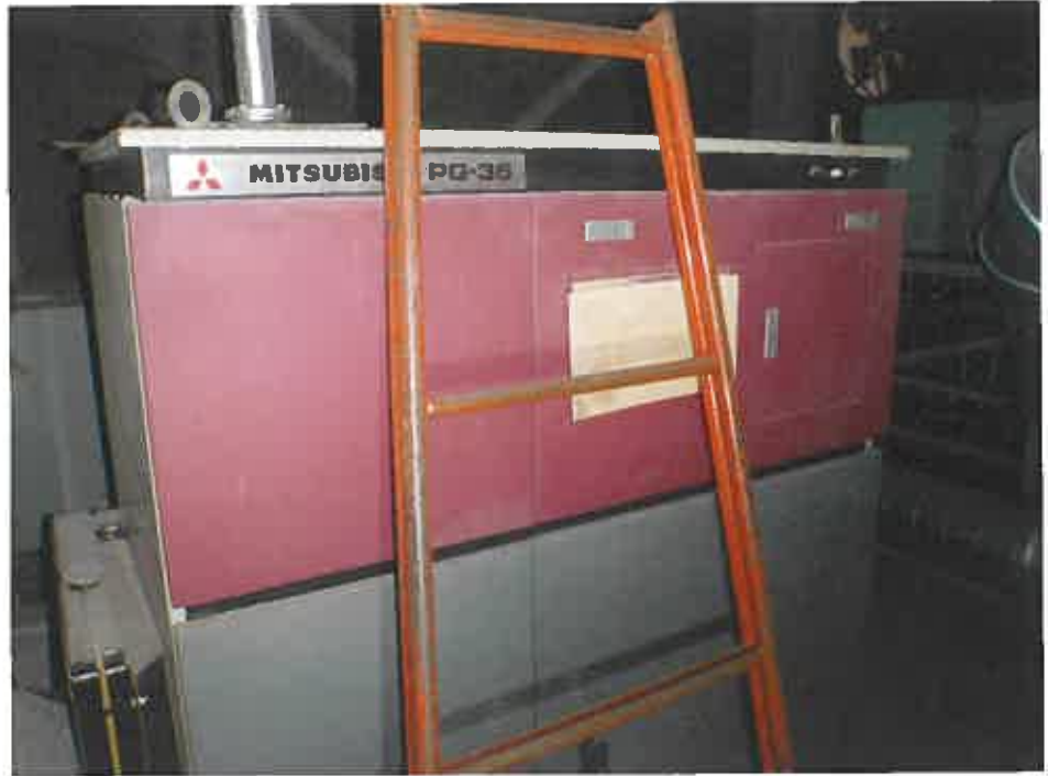
物件2 2階発電室
