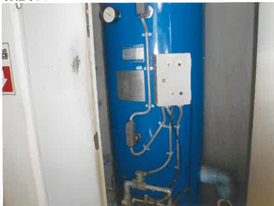
物件2 4階ボイラー
