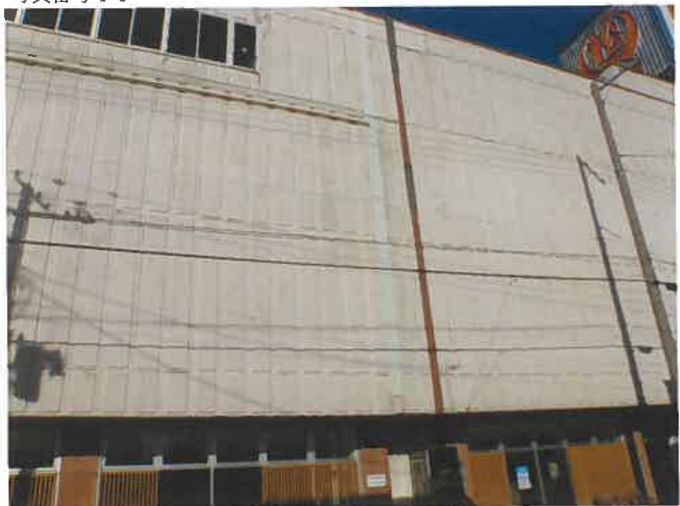
物件 2 南側外壁（補修されている模様）
