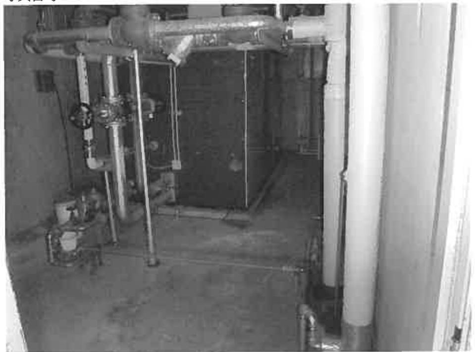
物件 2 3 階機械室
