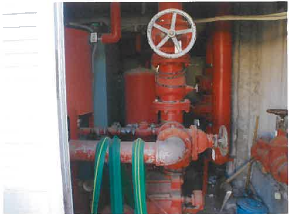
物件2 1階機械室
