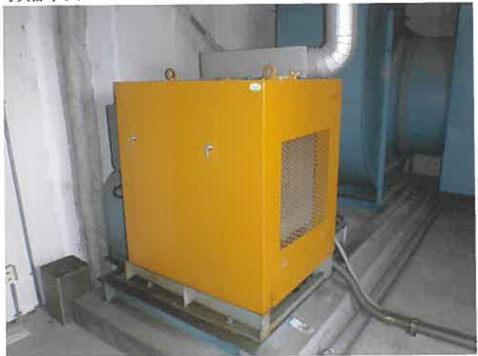
物件2 5階機械室
