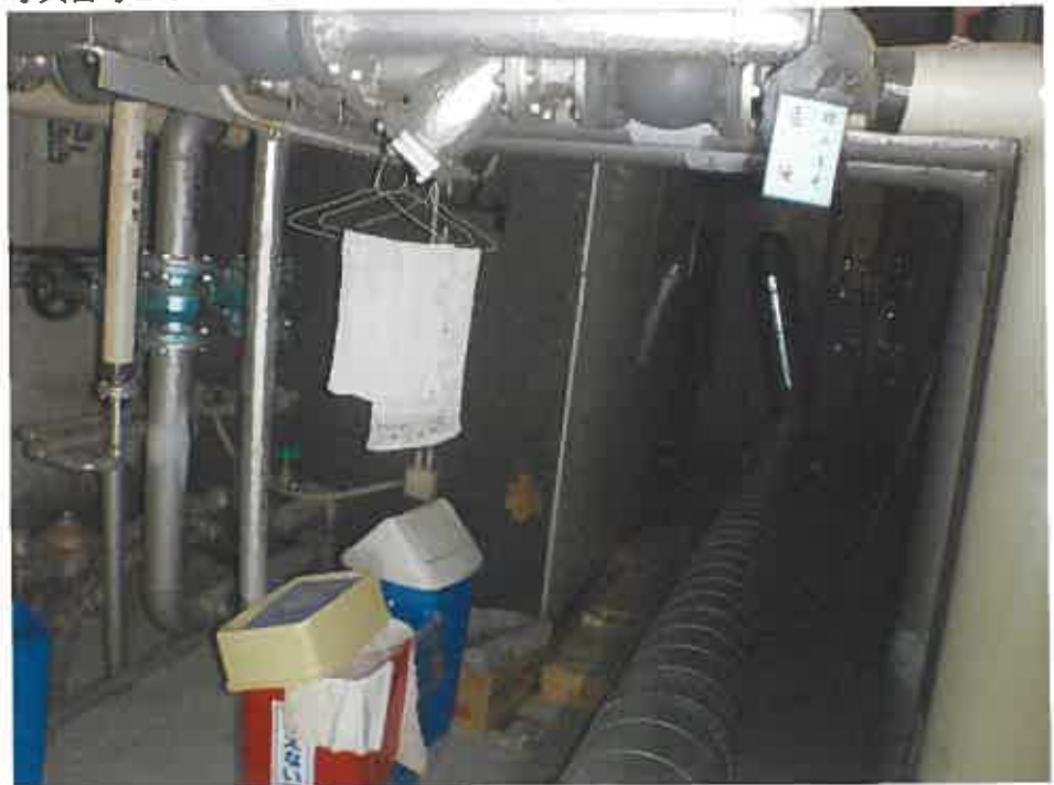
物件2 2階機械室
