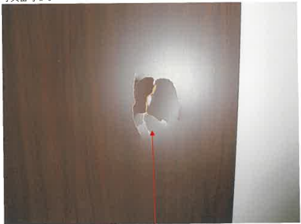
物件2 2階洋室（東側）収納扉の破損状況
