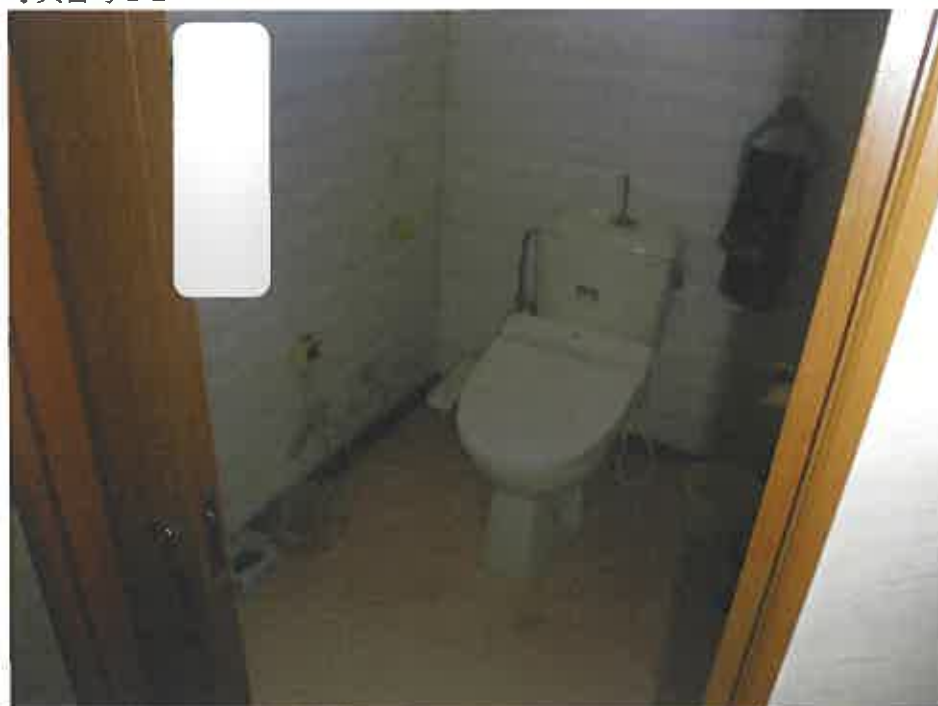
物件 2 2 階トイレ
