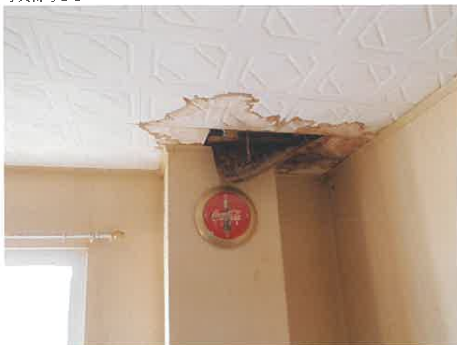
物件 2 2階洋室の天井部
