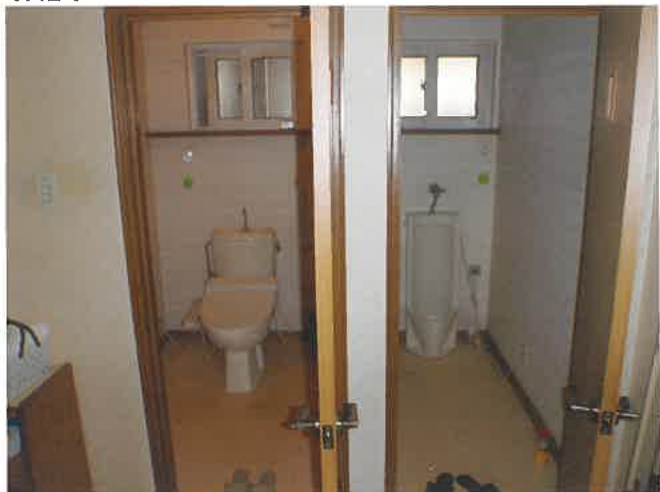
物件 2 1階トイレ
