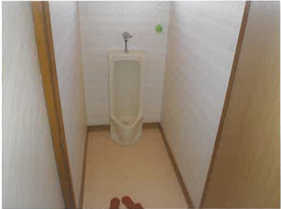
物件 2 2階トイレ
