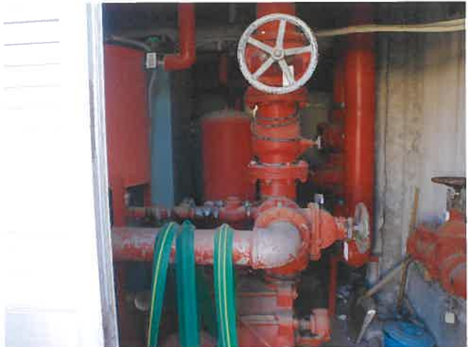
物件2 1階機械室
