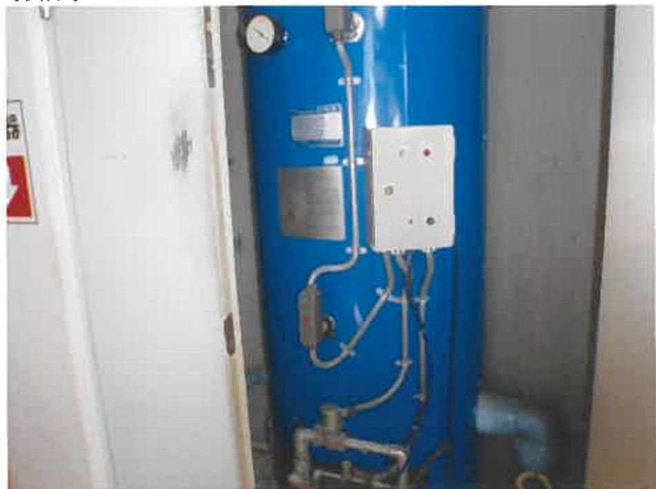
物件2 4階ボイラー
