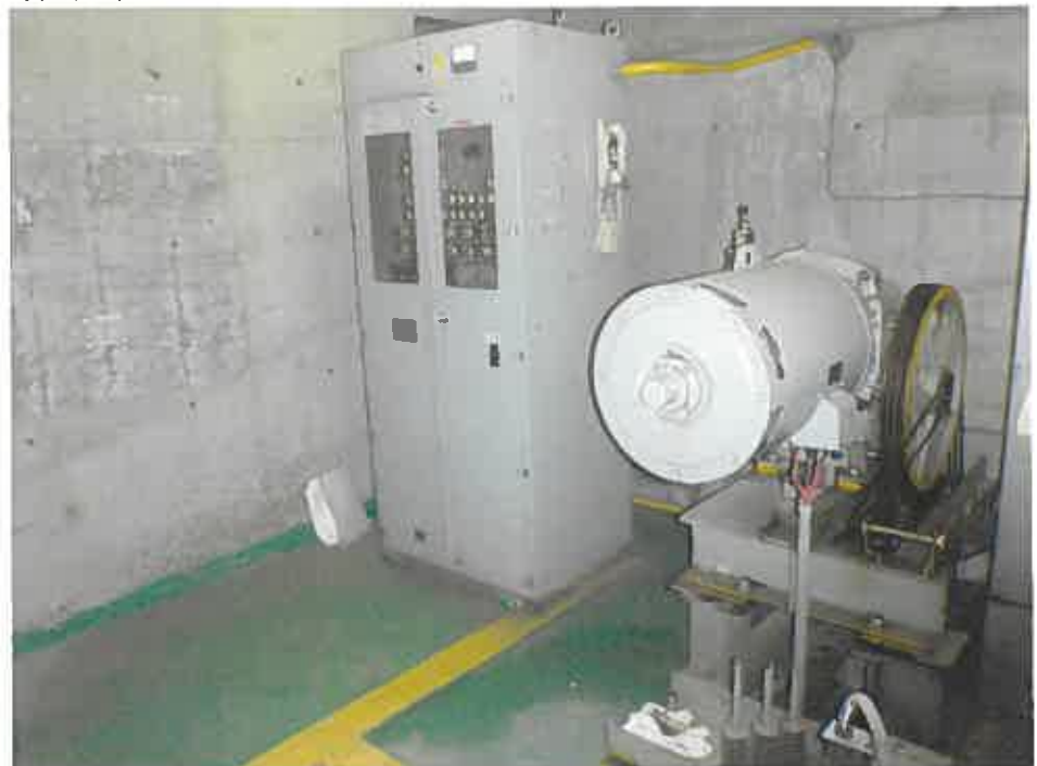
物件 2 5階エレベーター機械室
