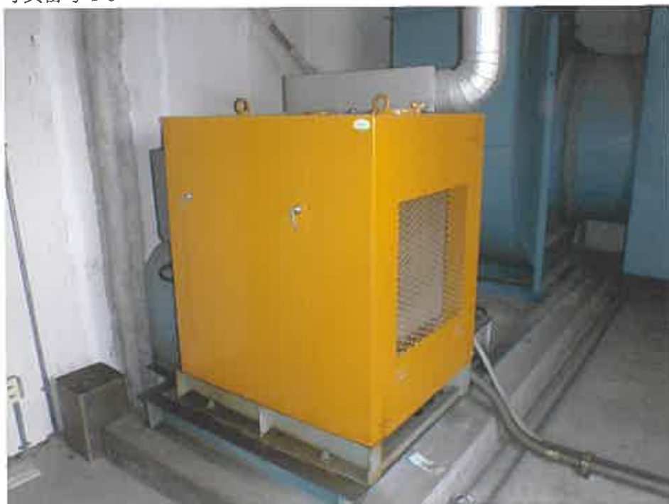
物件2 5階機械室
