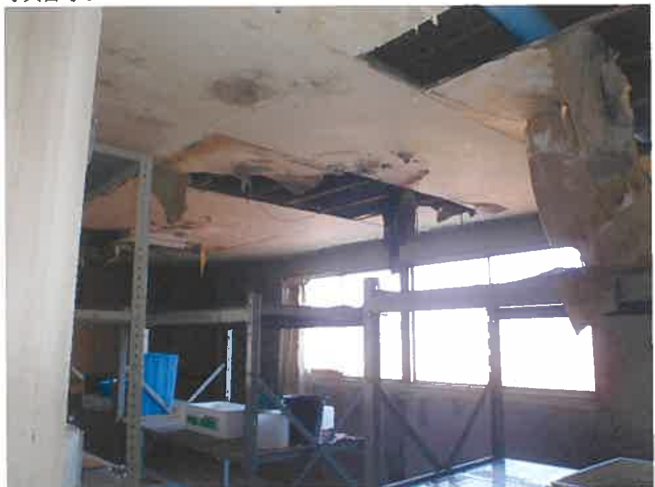
物件 2 4階倉庫 (天井が破損している)
