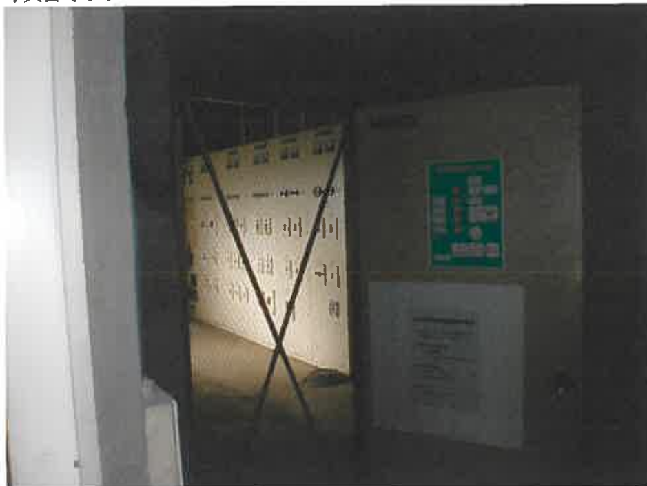
物件2 5階電気室
