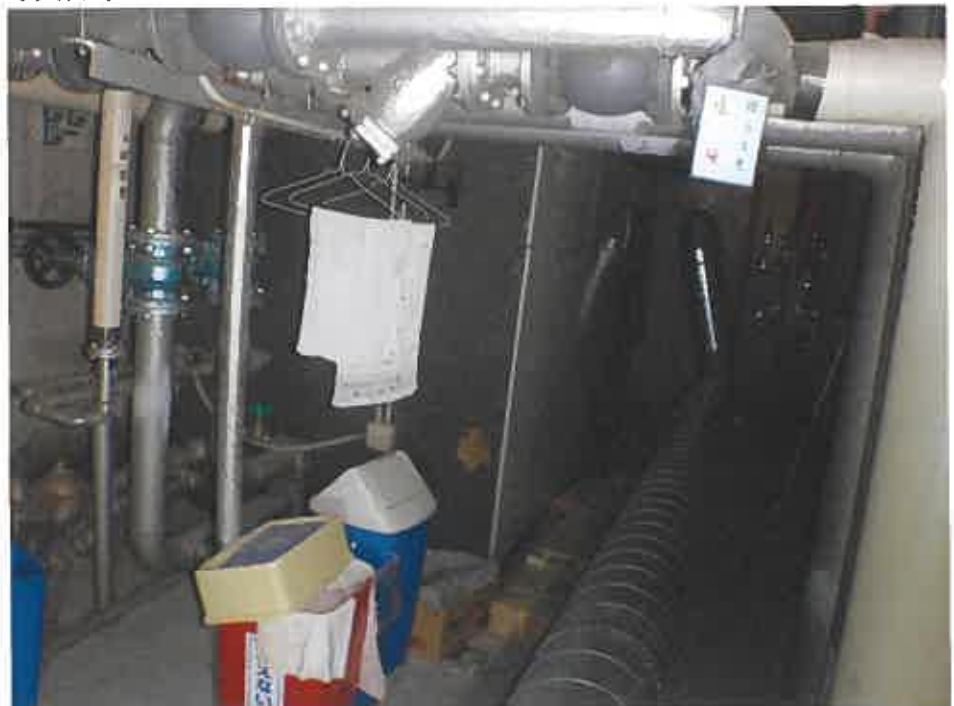
物件2 2階機械室
