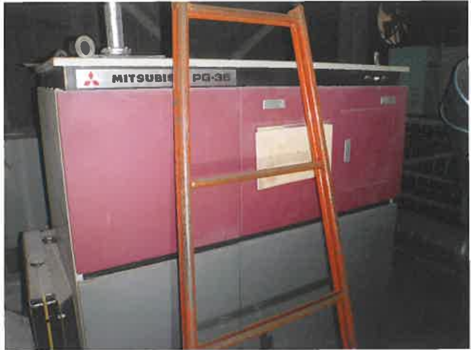
物件2 2階発電室
