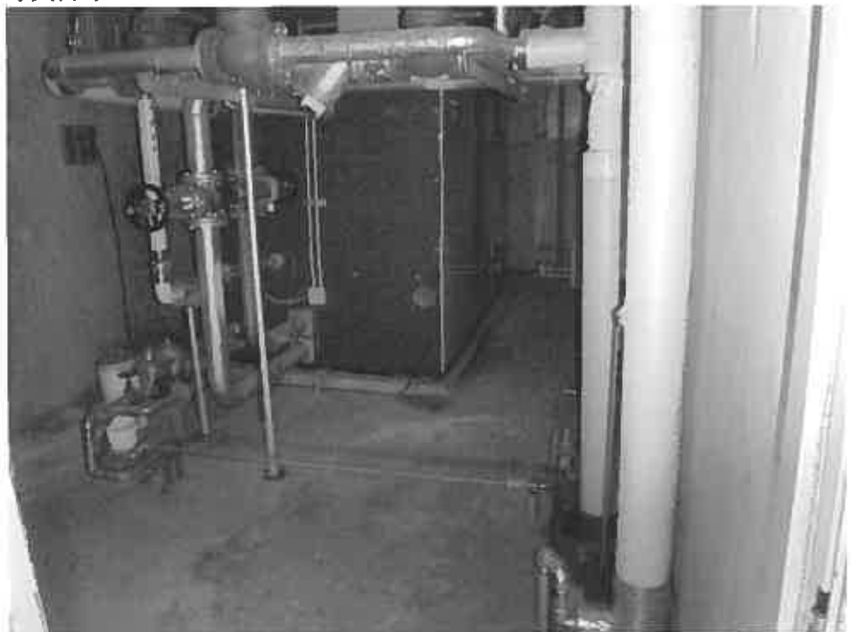
物件 2 3階機械室
