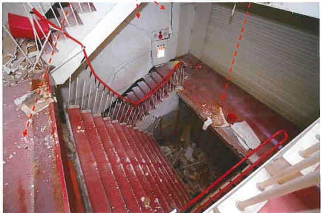
写真番号 6 踊り場 壁の亀裂 3階の床面
