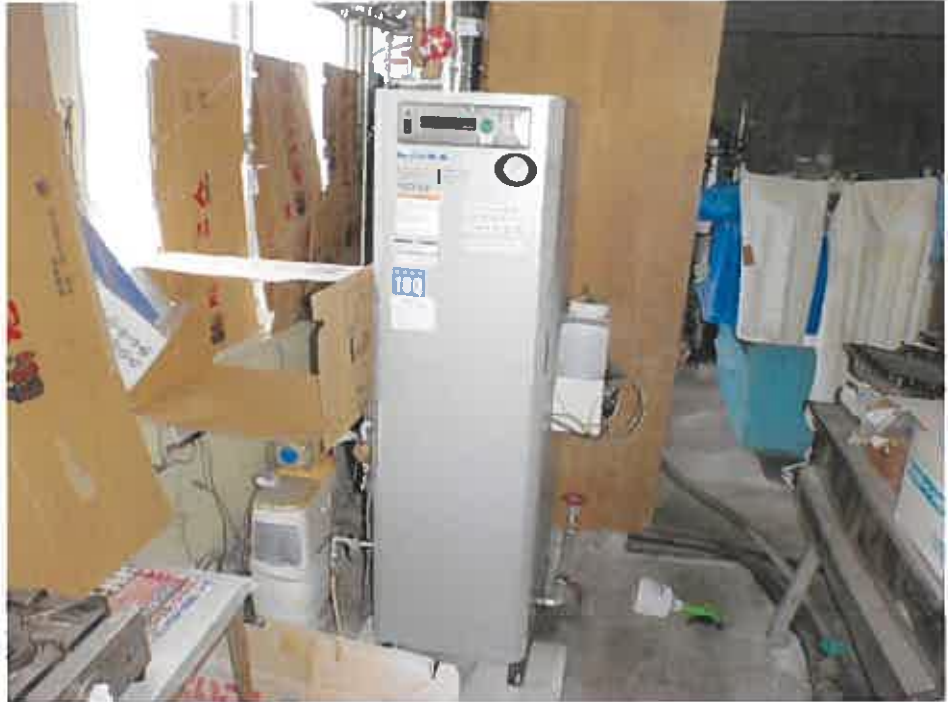
物件4 蒸気ボイラー
