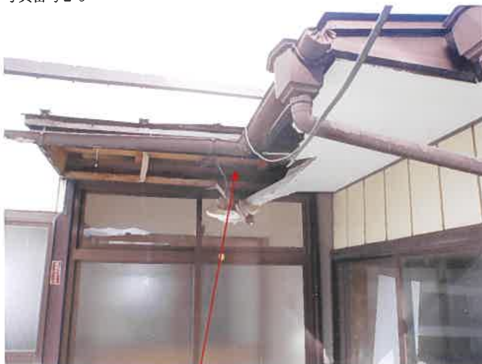
物件 5 玄関付近の底が破損している状況
