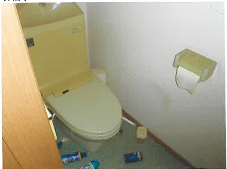
物件 2 2階トイレ
