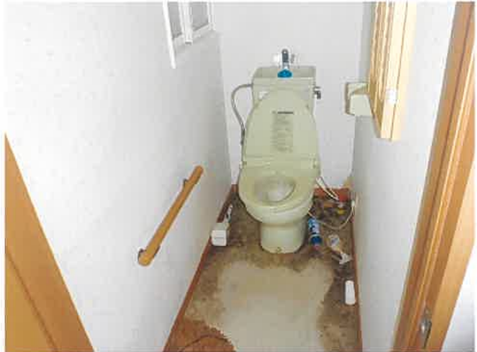
物件2 1階トイレ
