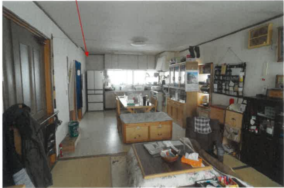
写真番号3 雨漏り跡
