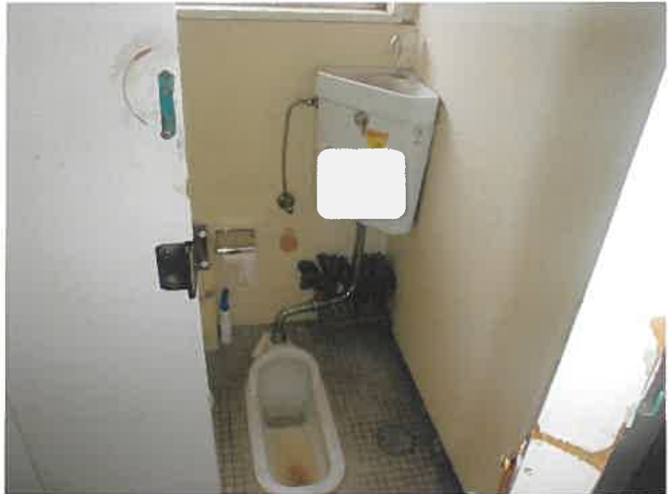
物件 2 2階トイレ
