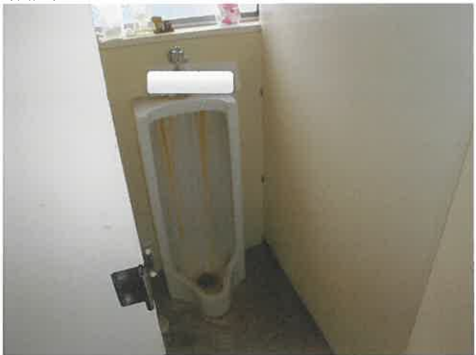
物件 2 2階トイレ
