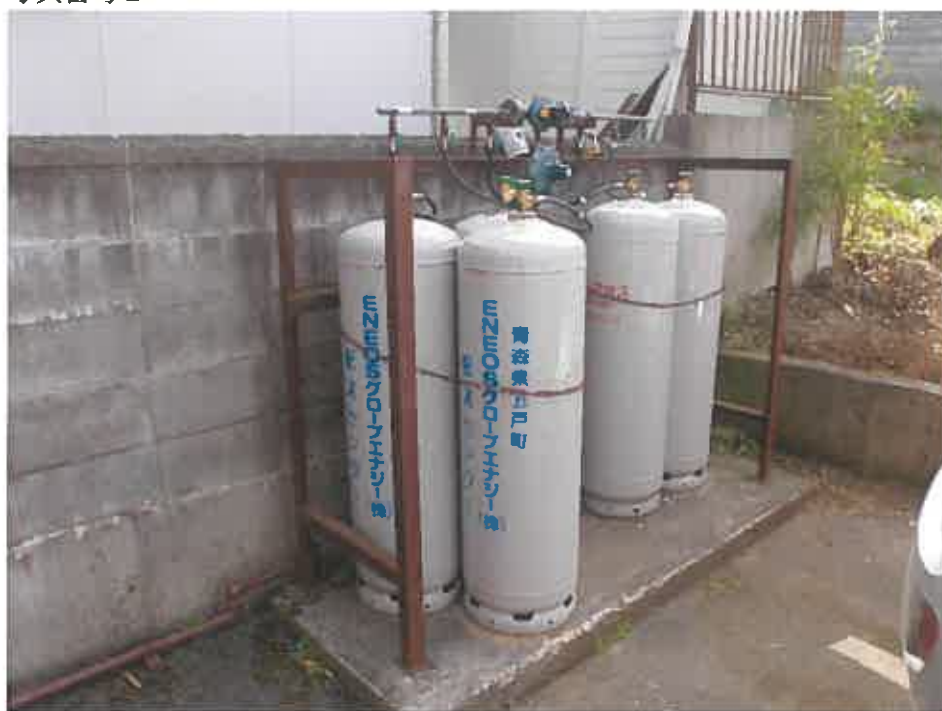
物件 1 上のガスボンベ
