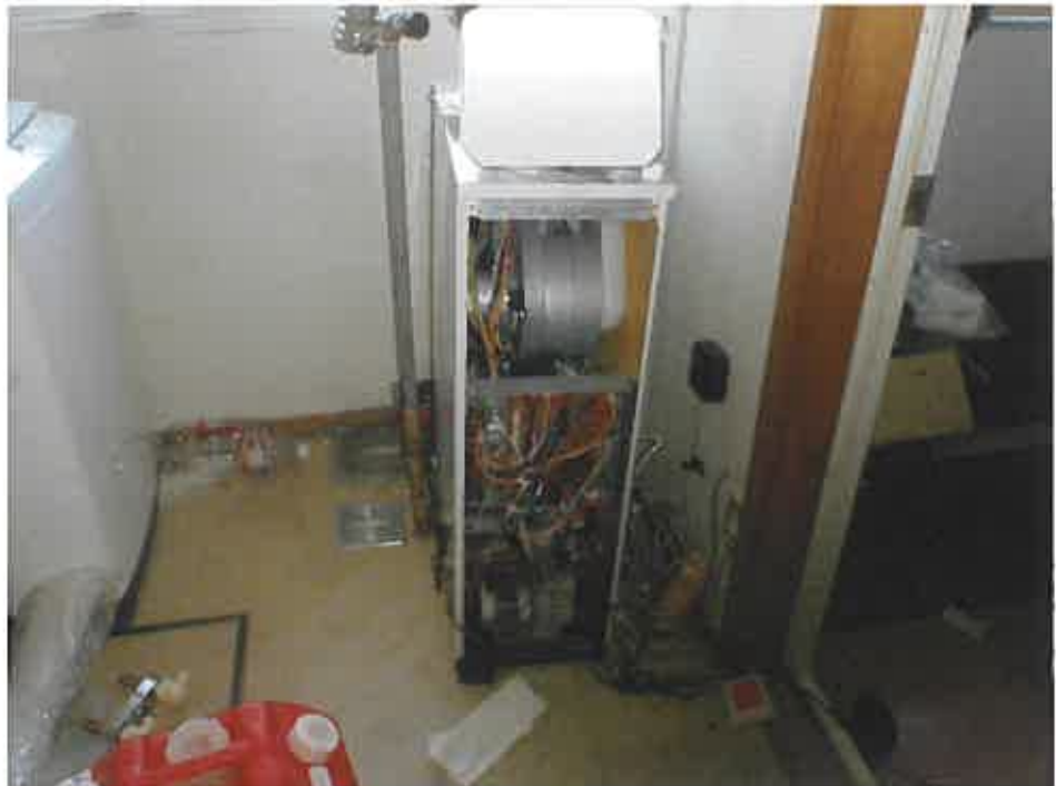
物件 2 ボイラー室
