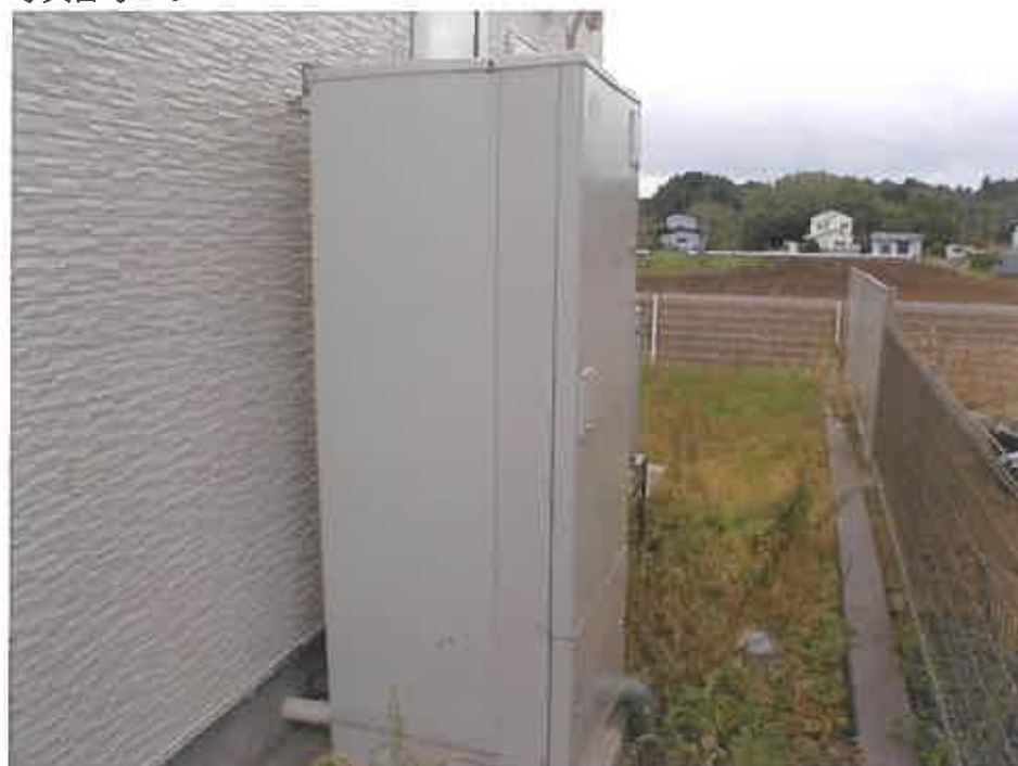
物件 2 ヒートポンプ
