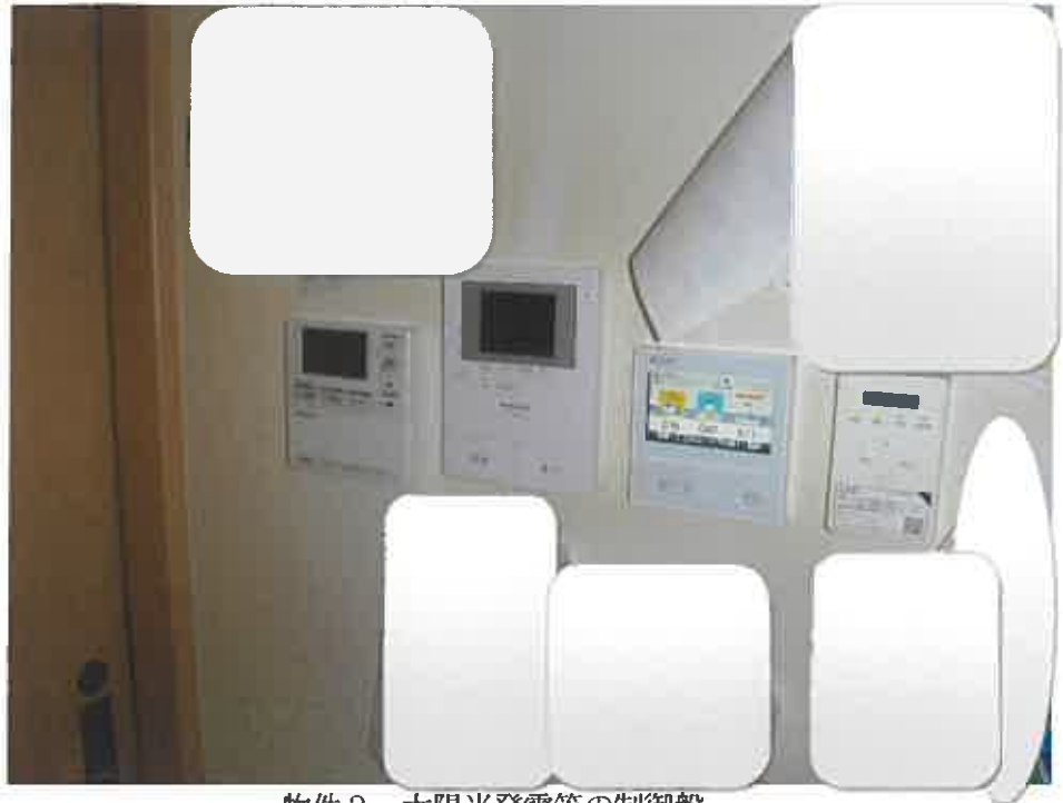
物件 2 太陽光発電等の制御盤
