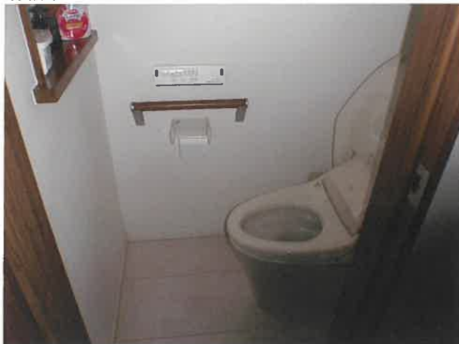
物件 3 1階トイレ
