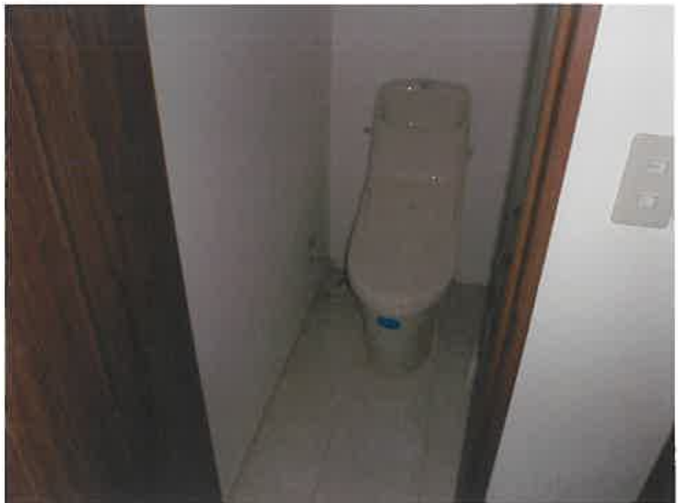
物件3 2階トイレ
