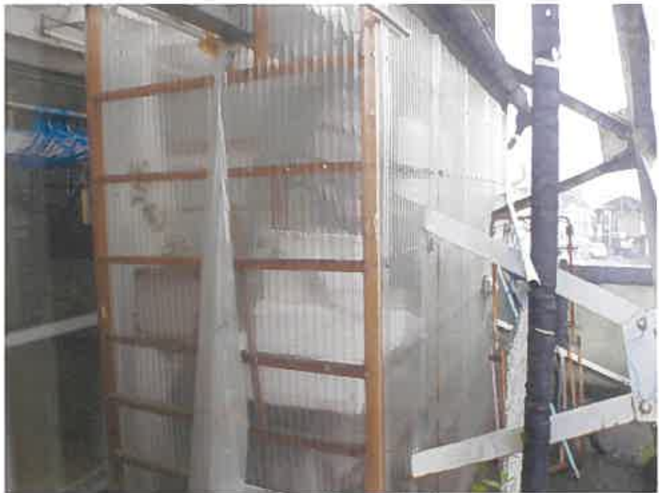
物件2 3階ベランダ部分の下屋
