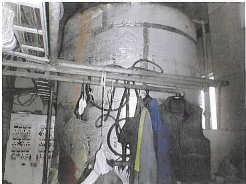
物件4 機械ボイラー室 (受水槽)
