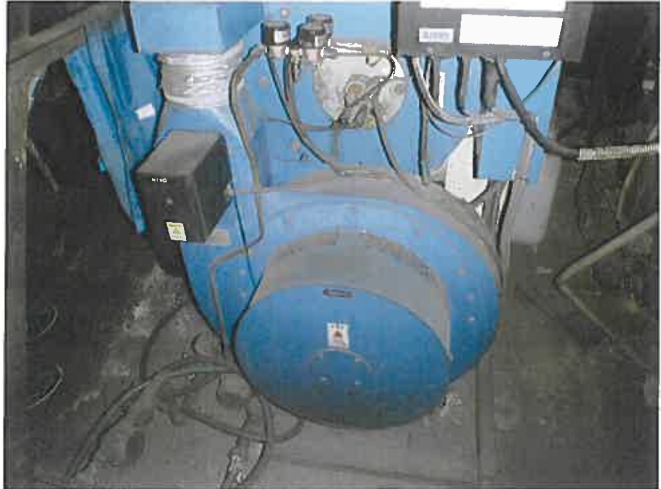
物件4 発電機室 (発電機)
