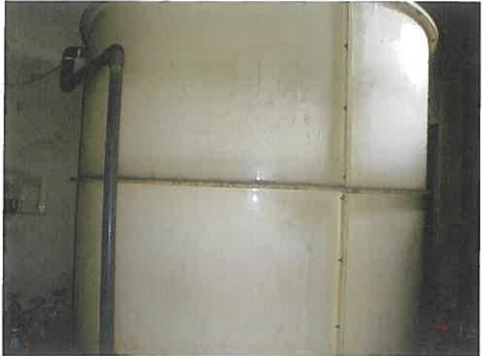
物件4 中2階 (受水槽)
