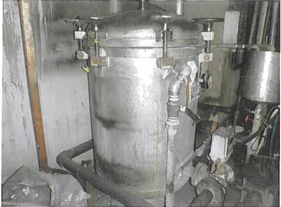
物件 4 機械ボイラー室 (濾過器)
