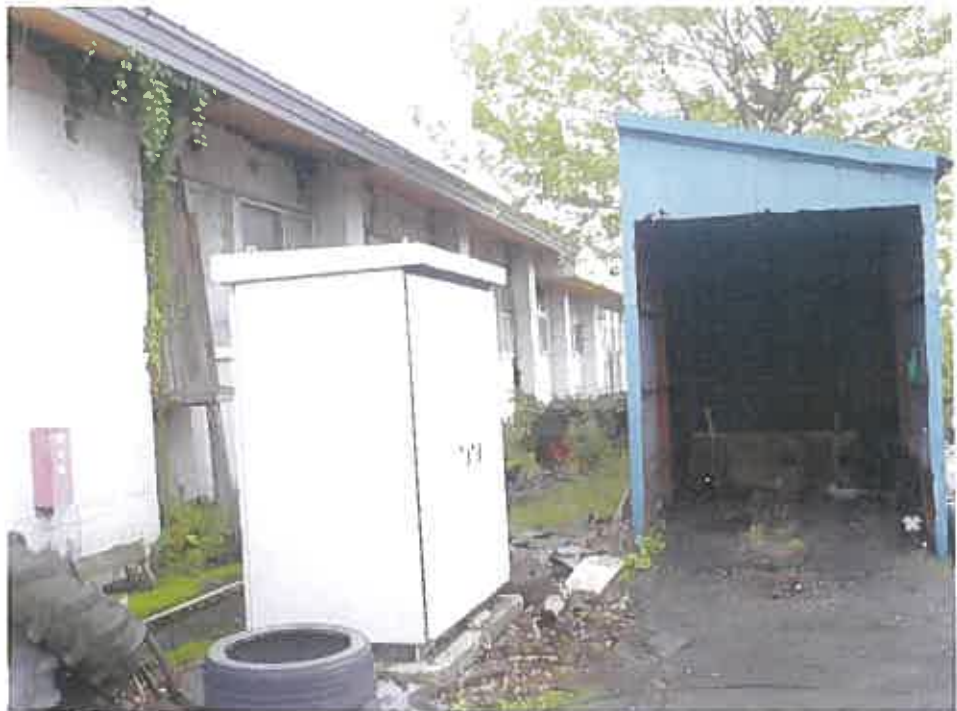
物件 1 上の工作物（車庫）とキュービクル
