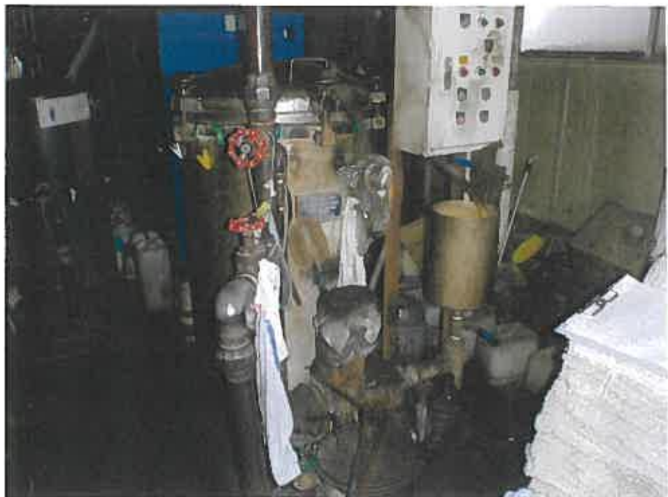
物件 4 機械ボイラー室 (ボイラー・受水槽)
