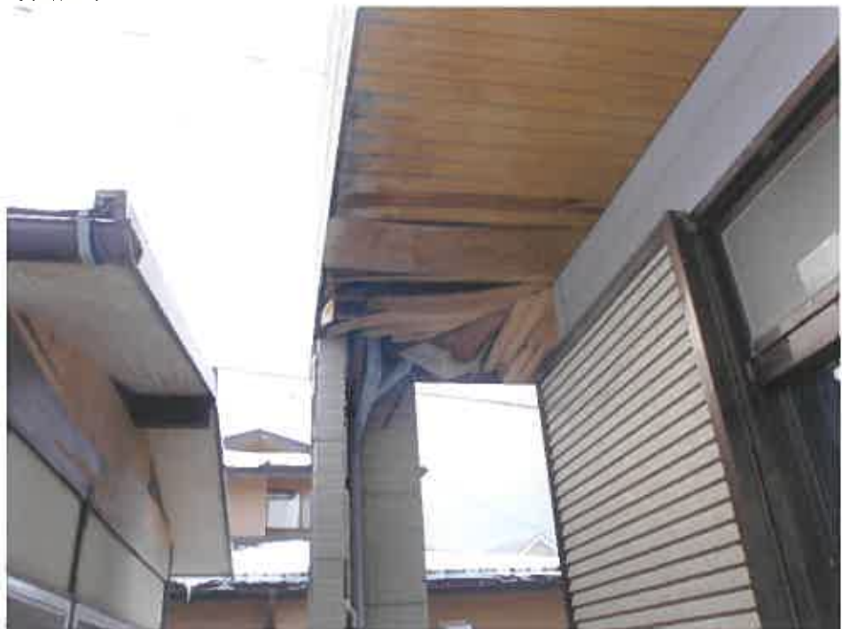
物件2 2階バルコニー部分の破損状況
