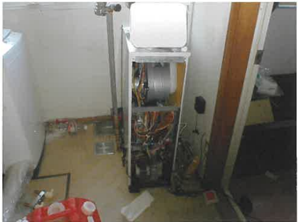
物件2 ボイラー室
