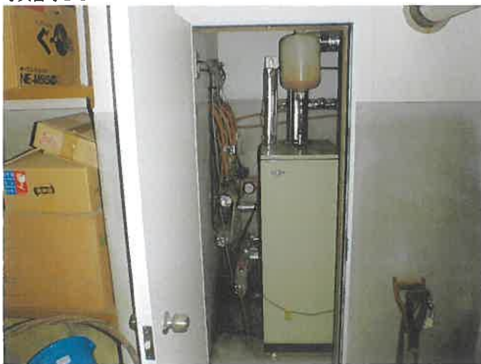
物件2 ボイラー室
