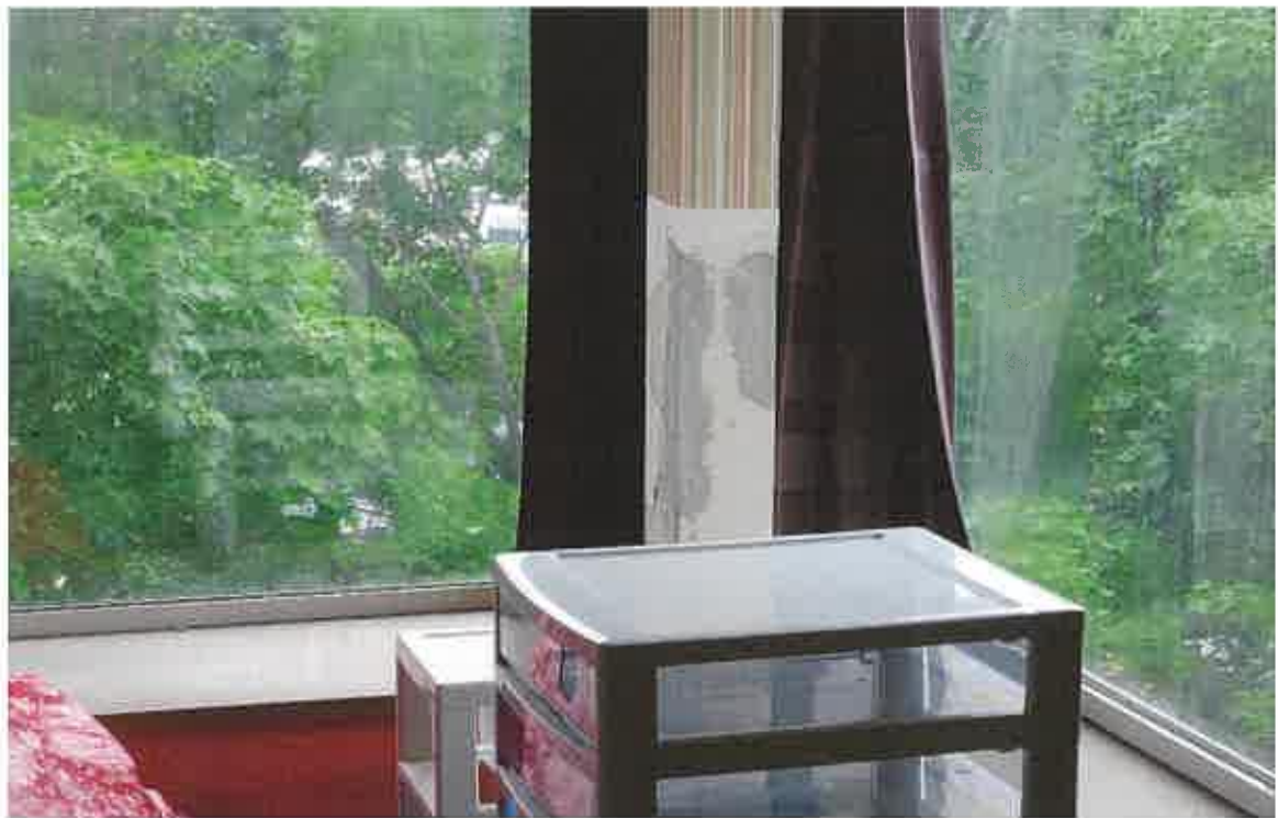
5 2階洋室5の出窓付近に見られた動物による引っ掻き傷
