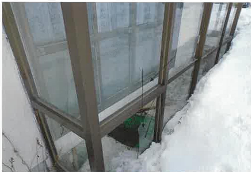
サンルーム ガラスの破損
