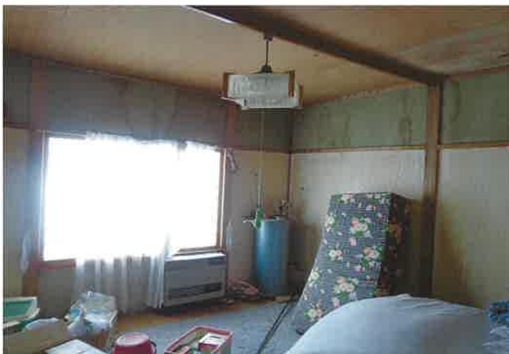
和室3 内壁の汚損
