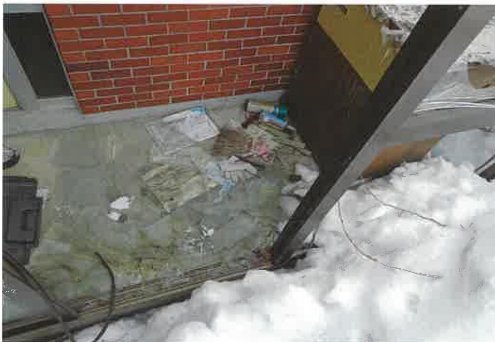
風除室 ガラスの破損
