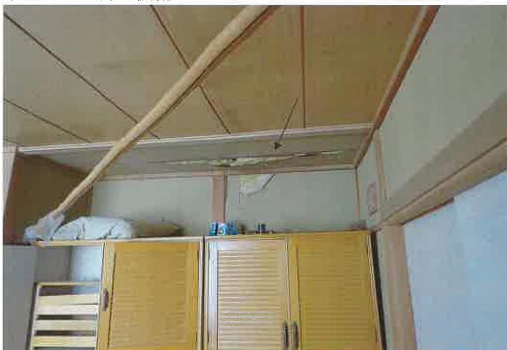
和室2 天井の損傷
