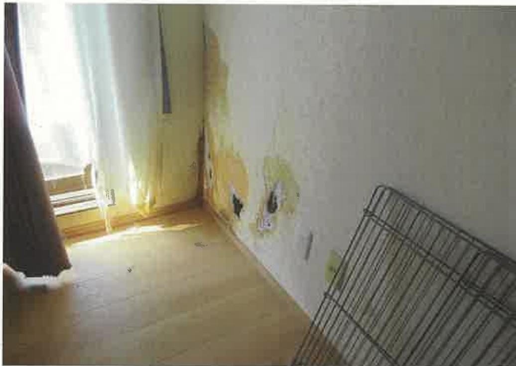
9 1階居間の壁（穴の状況）①
