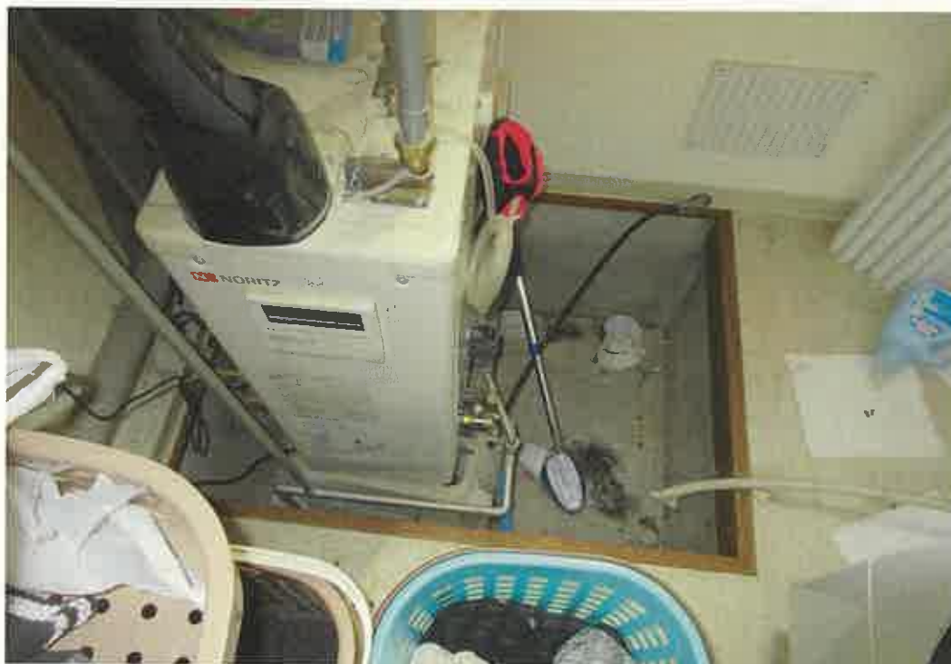
12 灯油給湯器付近（ネズミの出入口）
