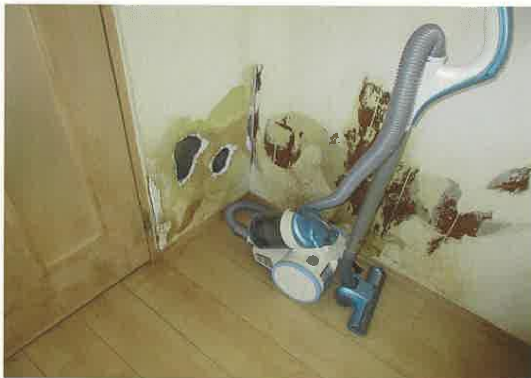
10 1階居間の壁（穴の状況）②
