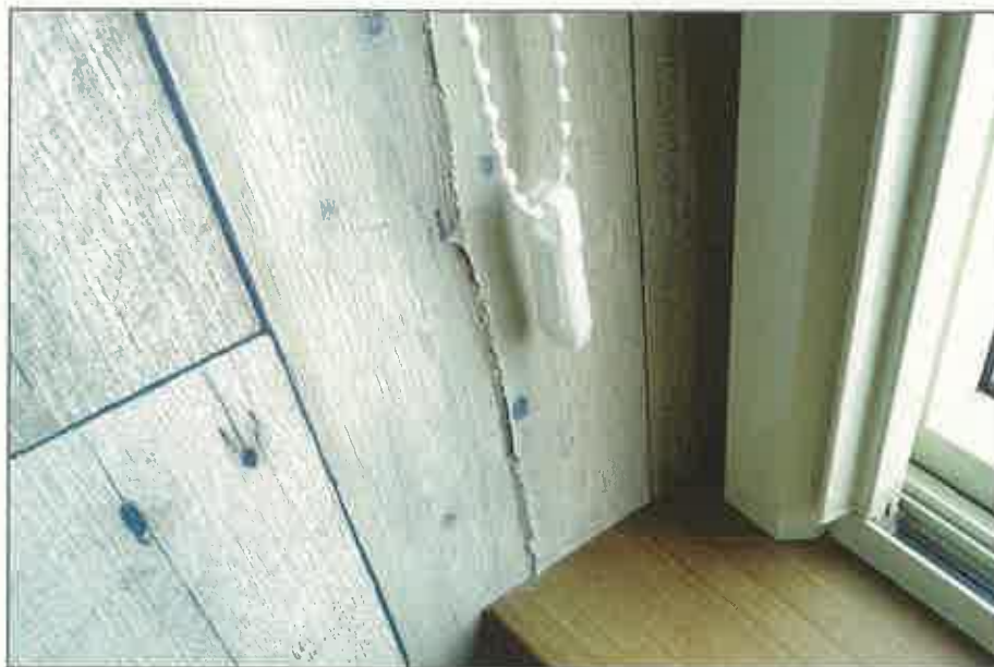
⑦2階廊下東側窓付近の亀裂の状況
