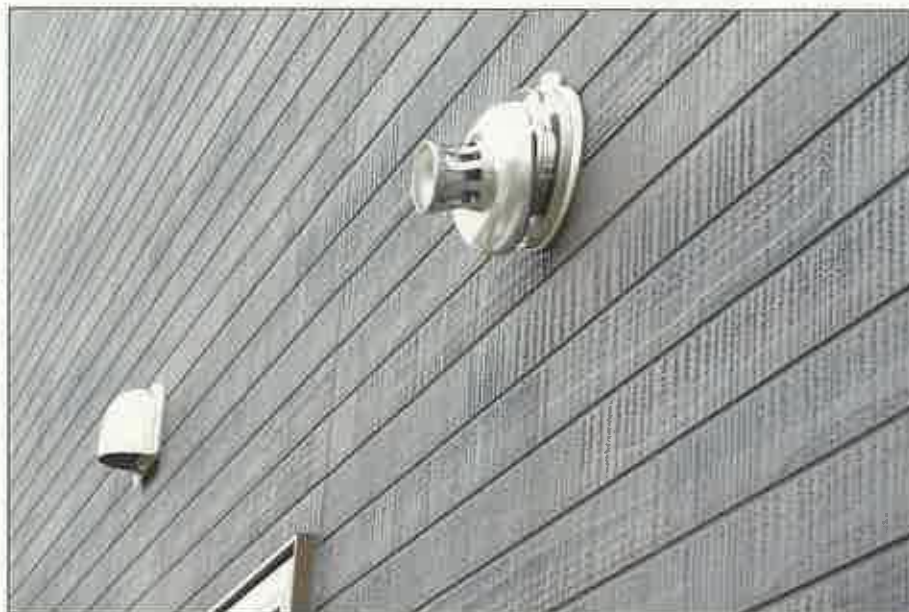
⑧北側外壁の排気口の損傷状況
