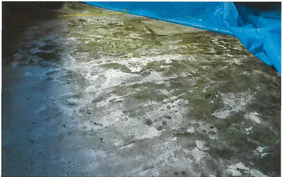
1 3 床の汚損状況（物件7）
