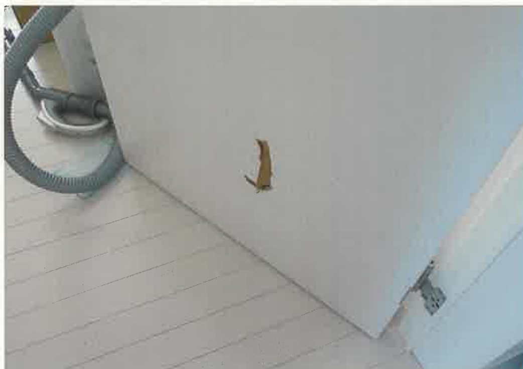
10 2階洋室2ドア（損壊状況）②
