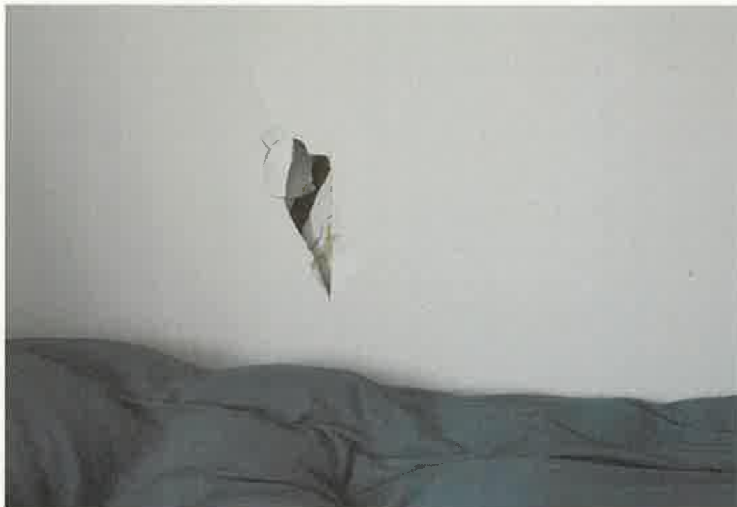
11 2階洋室3壁（損壊状況）
