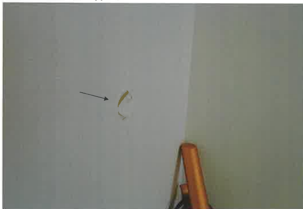
台所付近の壁紙の剥がれ
