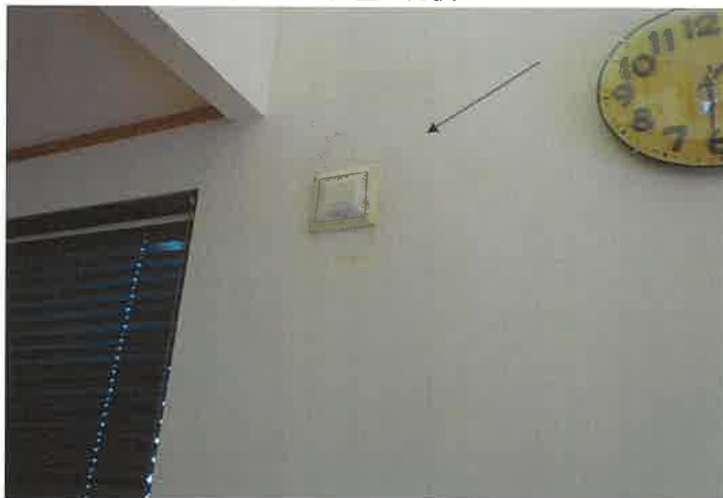
居間・食堂 換気扇付近の内壁の汚損
