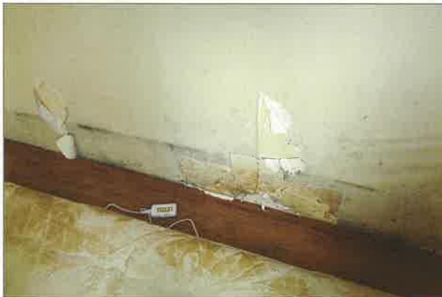
⑮洋室2の壁の状況
