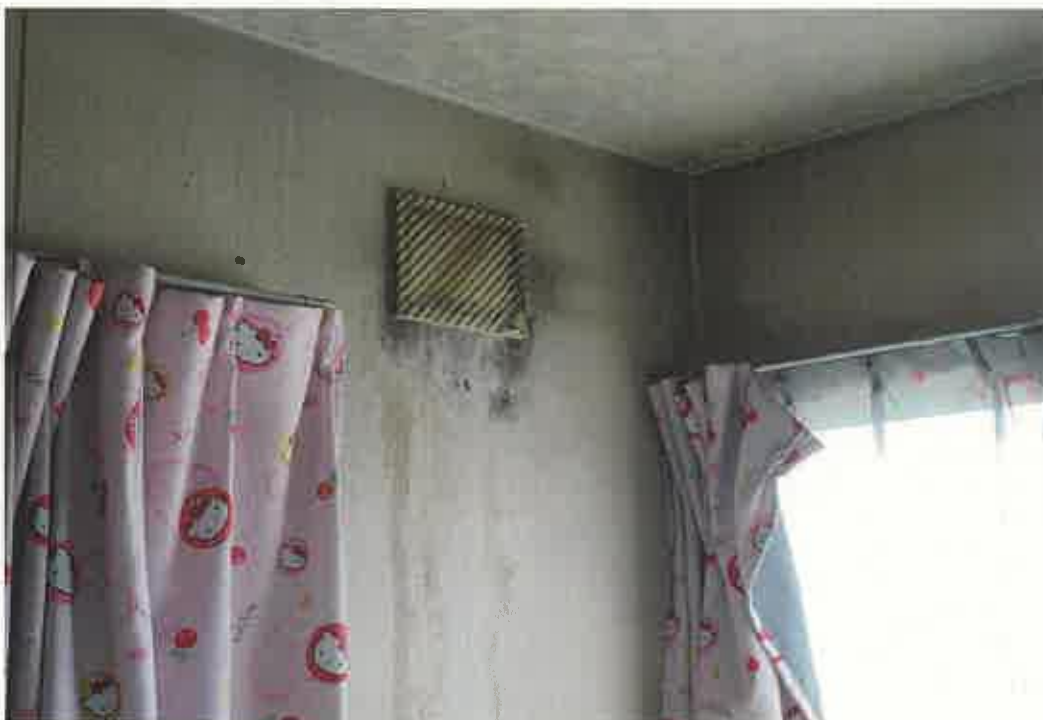
6 洋室1（汚損状況）
