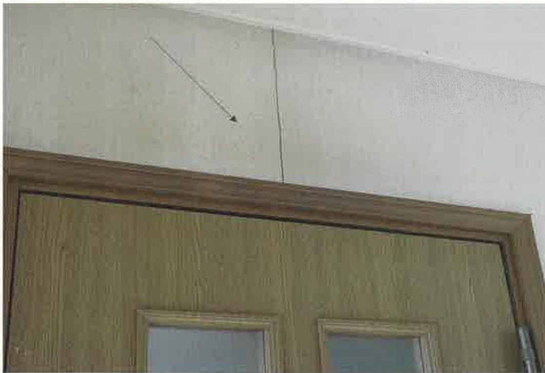
7 1階ホール出入口上部（亀裂状況）
