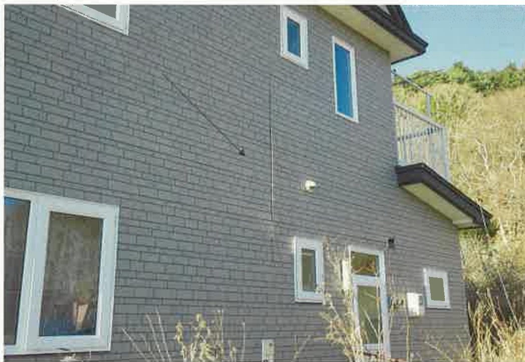
5 外壁（浮いている状況）
