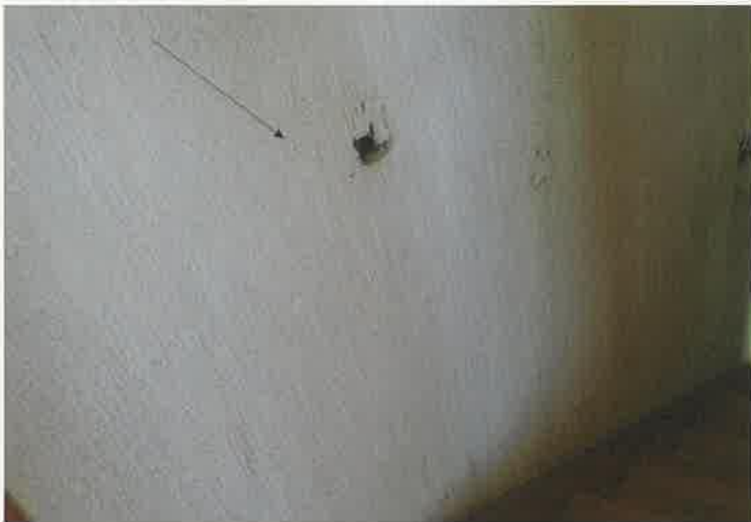
8 階段横壁（穴の状況）
