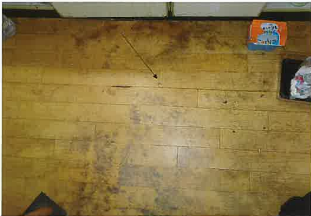
食堂・台所 流し台付近の床の汚損
