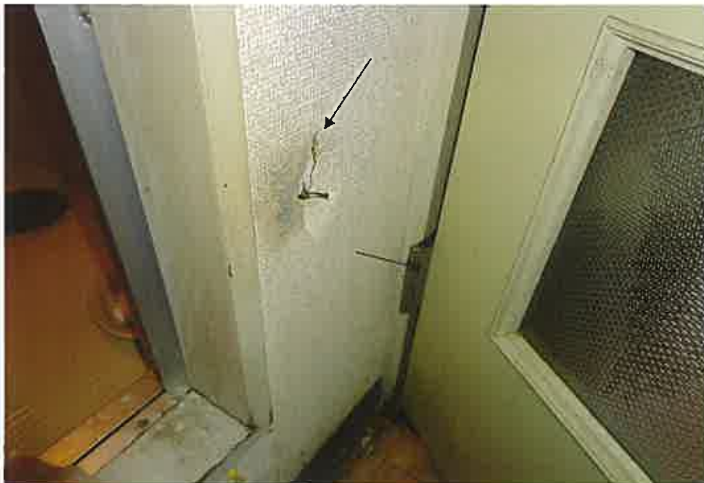
浴室のドア付近の内壁の穴
