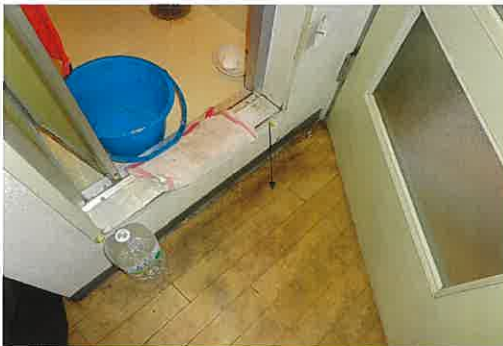
浴室のドア下部の汚損
