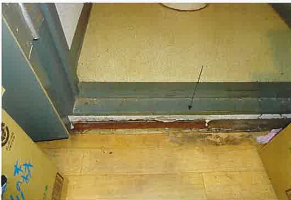
トイレのドア付近の内壁の破損
