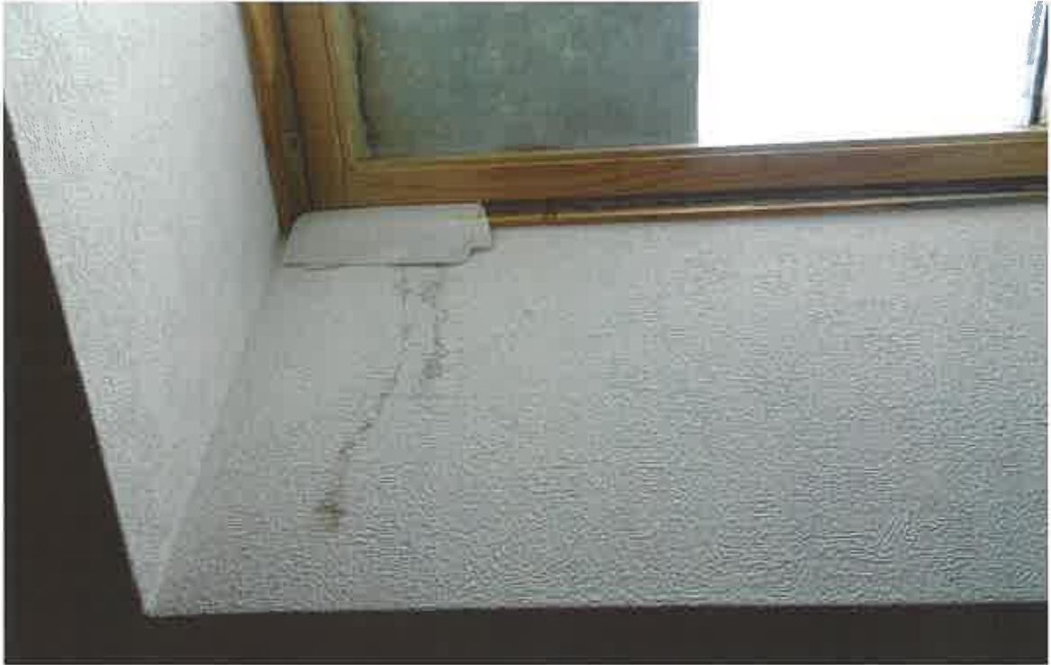
5 2階洋室2の天窓付近に見られたすが漏り
