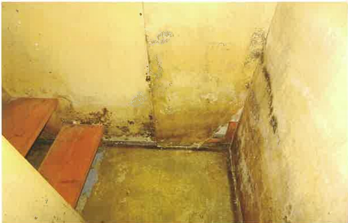
6 地下1階階段の内壁の汚損状況等
