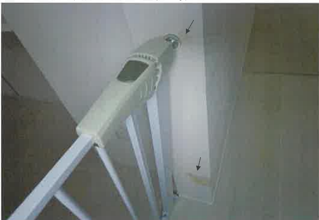
キッチン横 食品庫付近の壁紙の剥がれ
