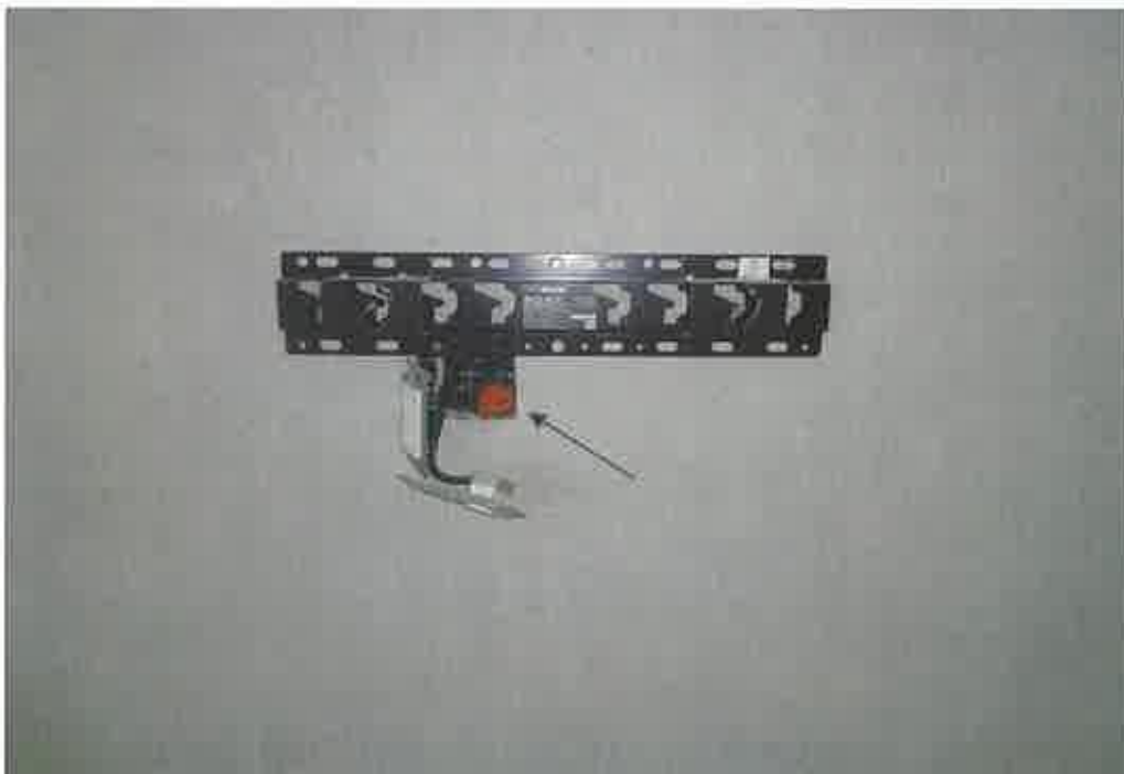
居間・食堂 内壁の穴
