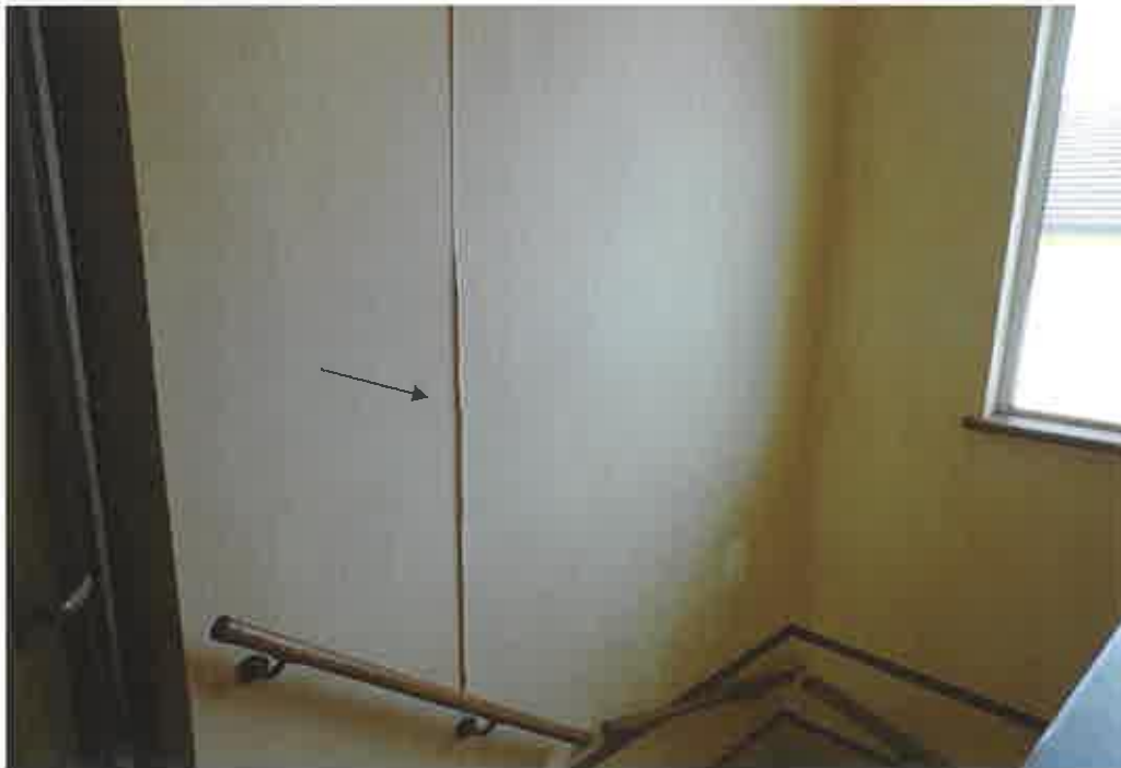
階段中腹の壁紙の剥がれ
