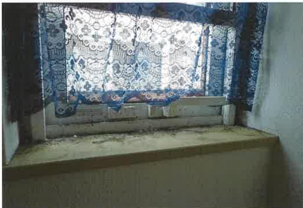
玄関横 小窓付近の黒カビの状況
