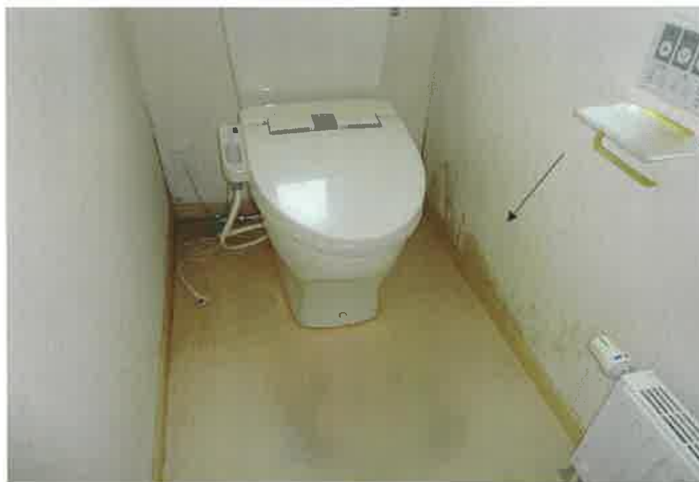
トイレ 内壁の汚損
