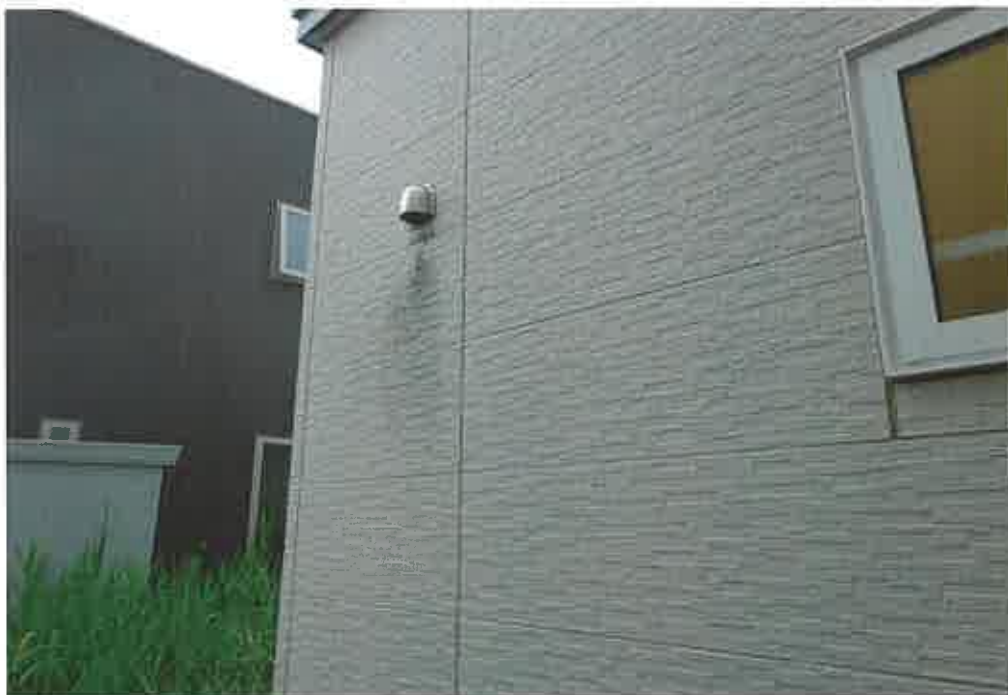
西側の外壁 換気口付近の汚損
