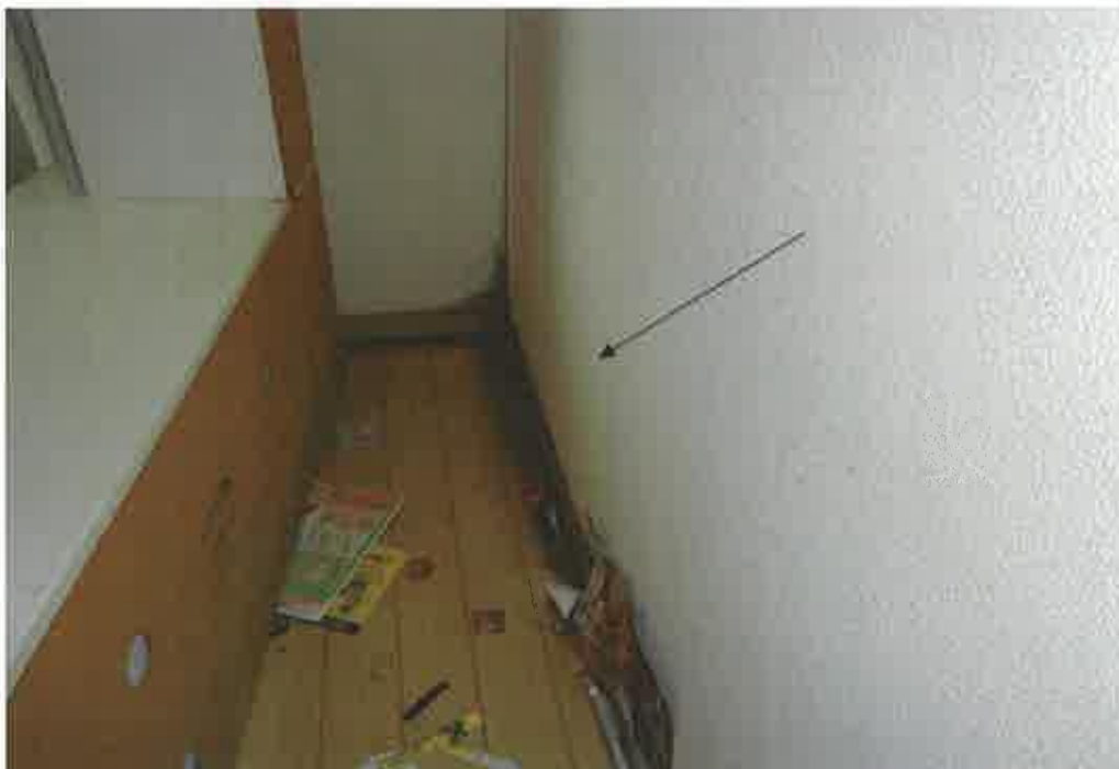
居間 内壁の黒カビの状況
