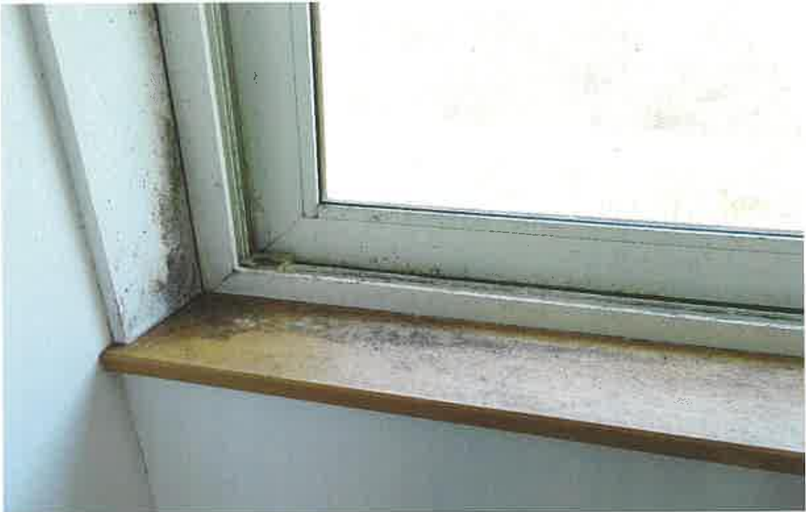
6 2階洋室3の窓枠周囲に見られた湿気による汚損
