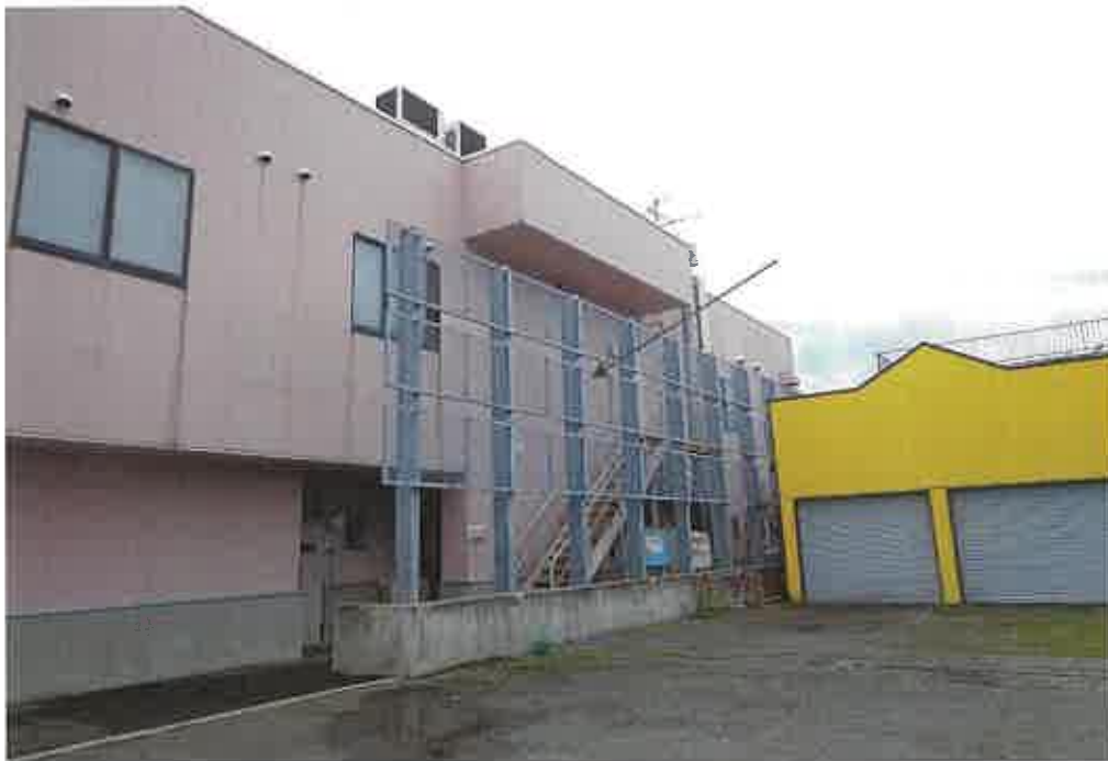
鉄製雪止めフェンス
