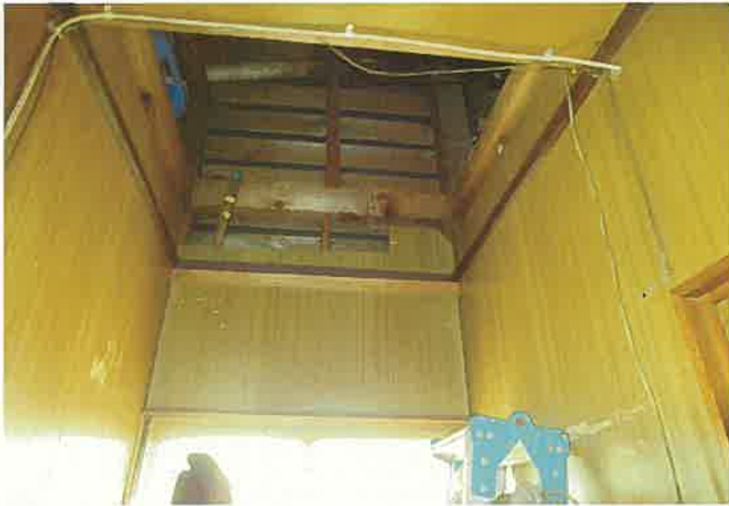
9 2階共用廊下部分天井板（剥離状況）
