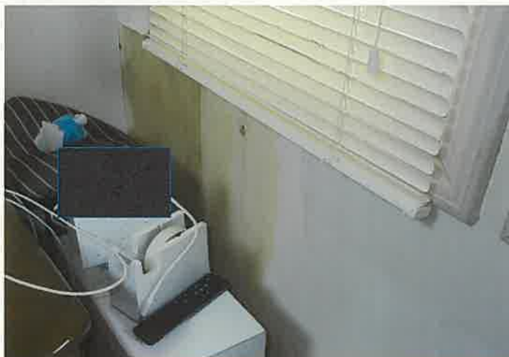
8 2階洋室2（事務室）壁紙（剥離状況）
