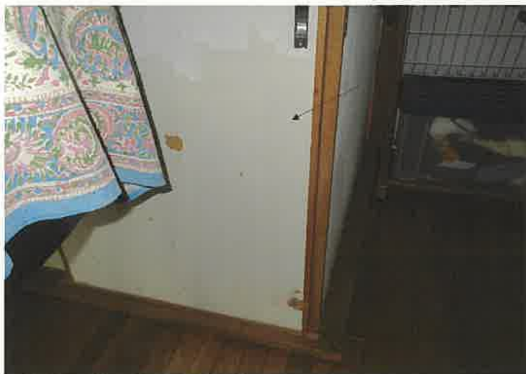
6 1階洋室1ふすま壁紙（剥離状況）
