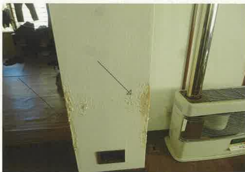
居間・食堂 クロスの状況
