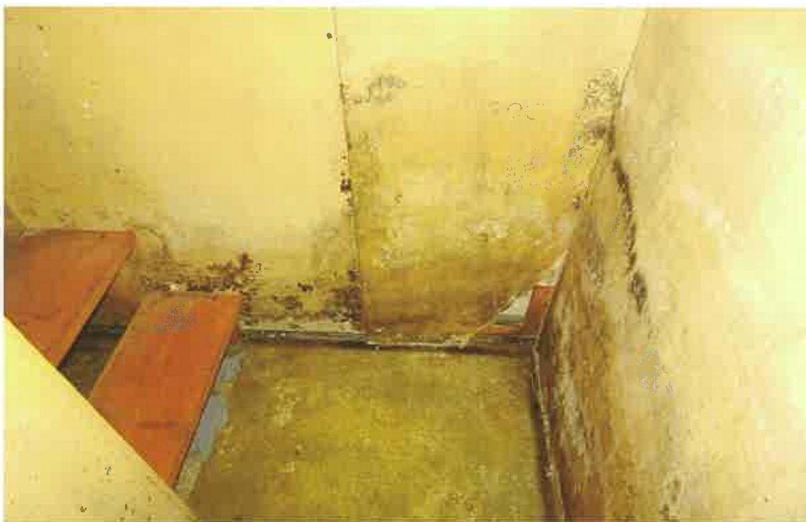
6 地下1階階段の内壁の汚損状況等
