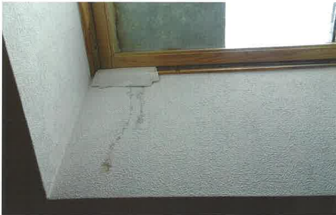
5 2階洋室2の天窗付近に見られたすが漏り
