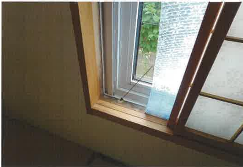
1 階和室の窓枠付近の結露による黒カビ
