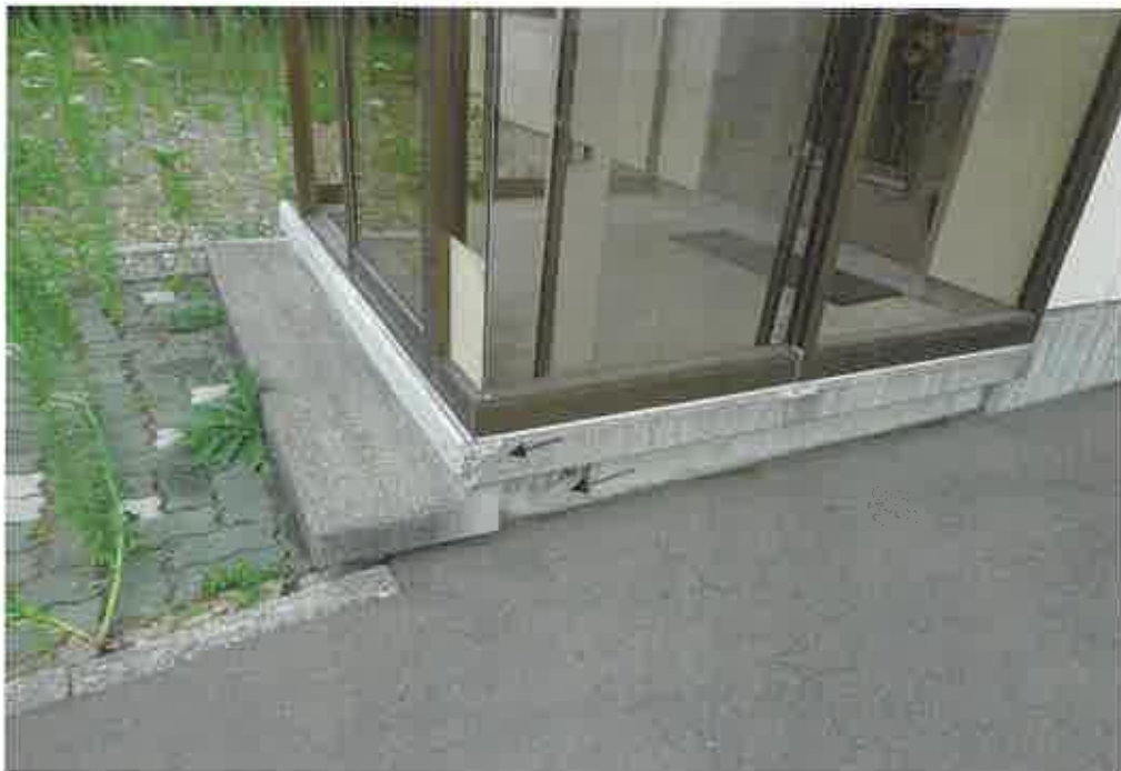
風除室付近の外壁の破損
