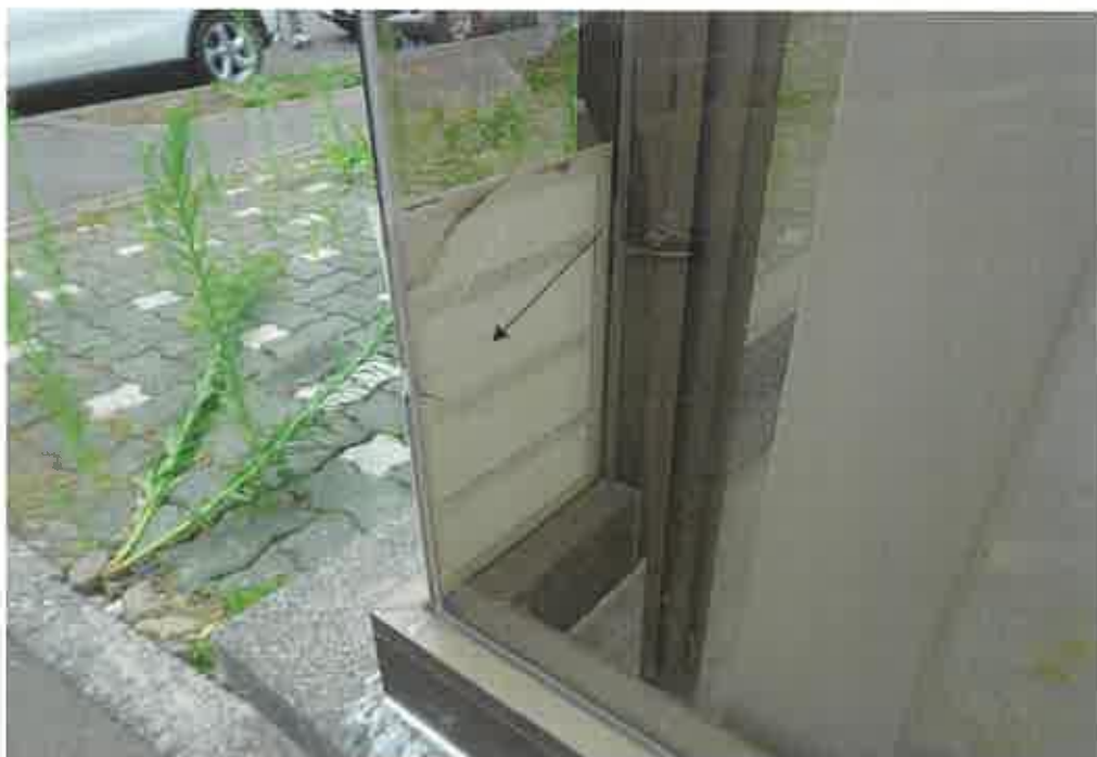
風除室のガラスの破損
