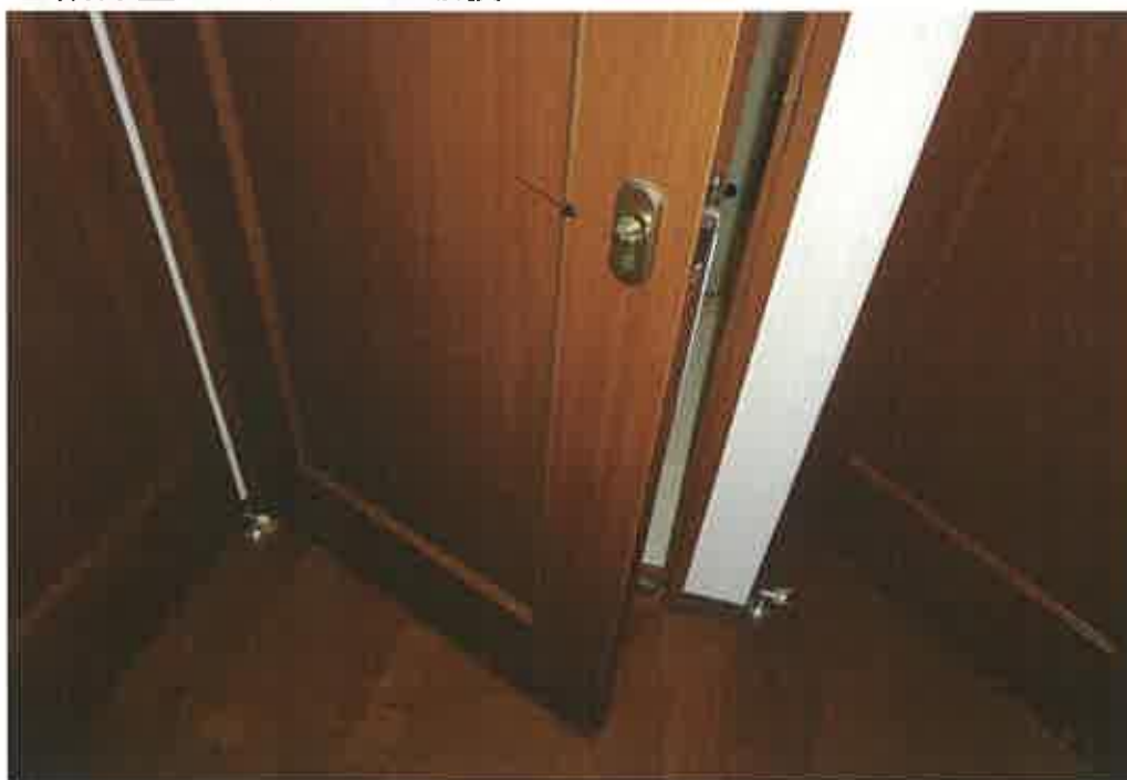
2 階洋室のドアノブの破損
