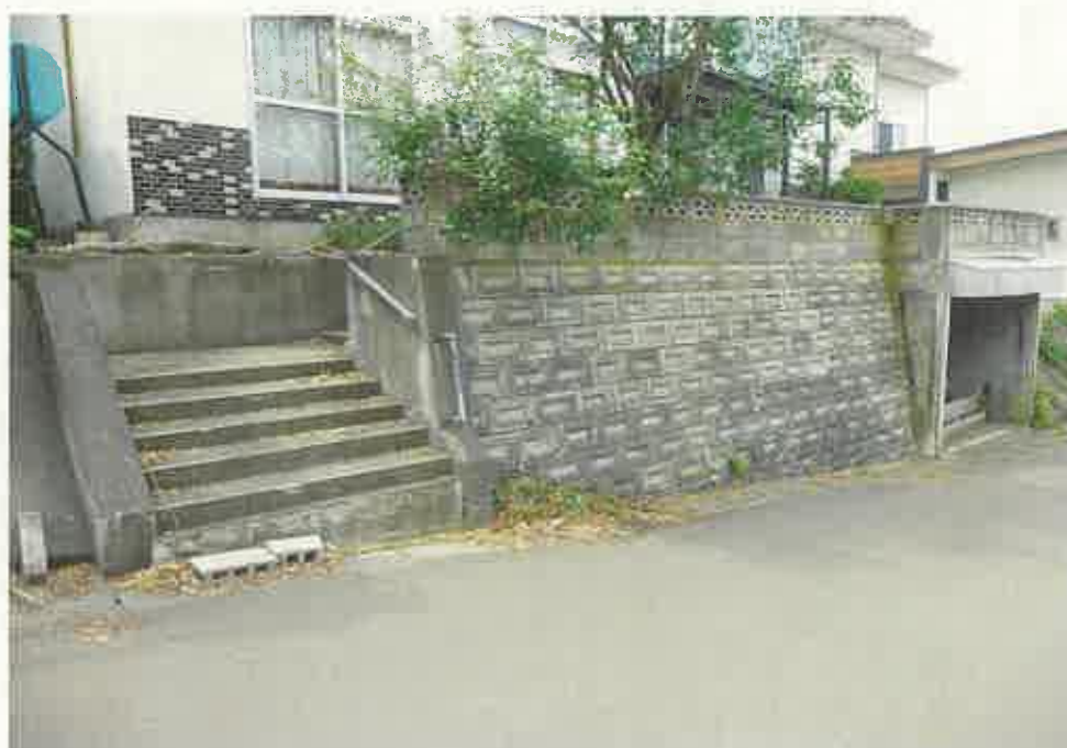
外階段、枝の状況、コンクリートブロック擁壁及びコンクリートブロック塀
